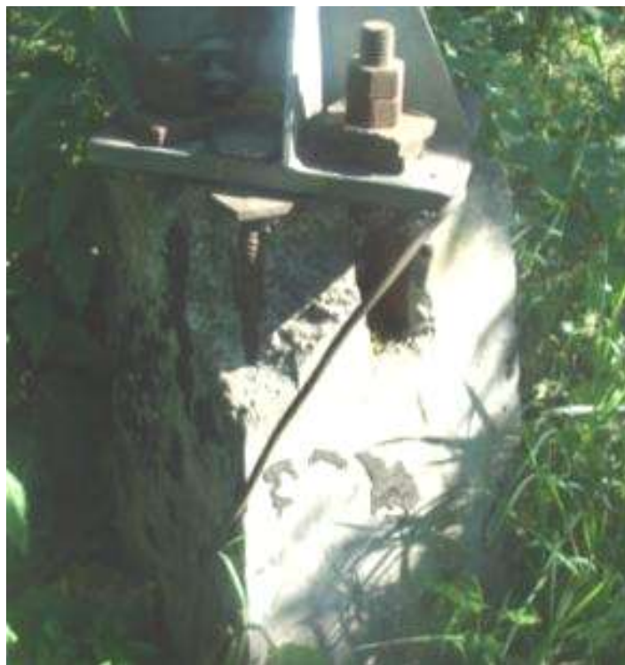
Фото 4. Сколы бетона фундамента, оголение и коррозия арматуры. Опора № 3.
