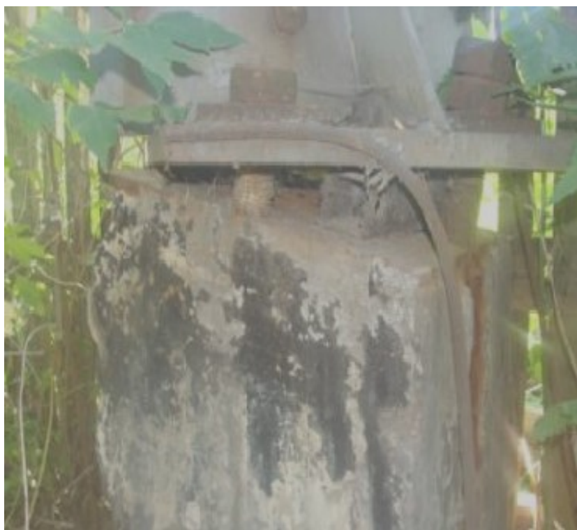
Фото 6. Несоответствие типа фундамента опорной части конструкции. Опора №3.
