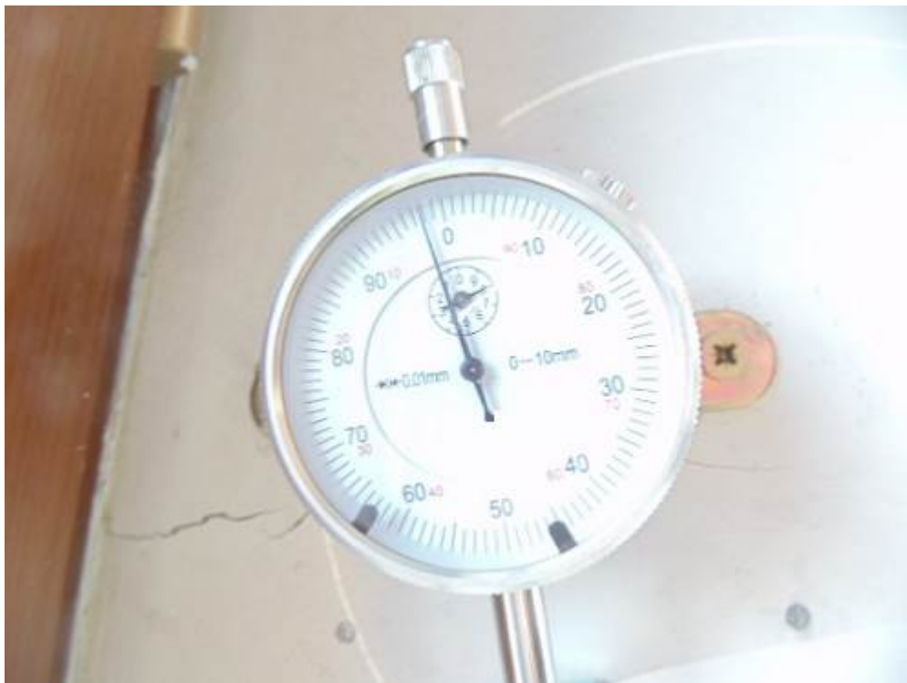
Фото 7. Фотофиксация показаний маяка (индикатора-щелемера) (замер 4) _____ Г.
