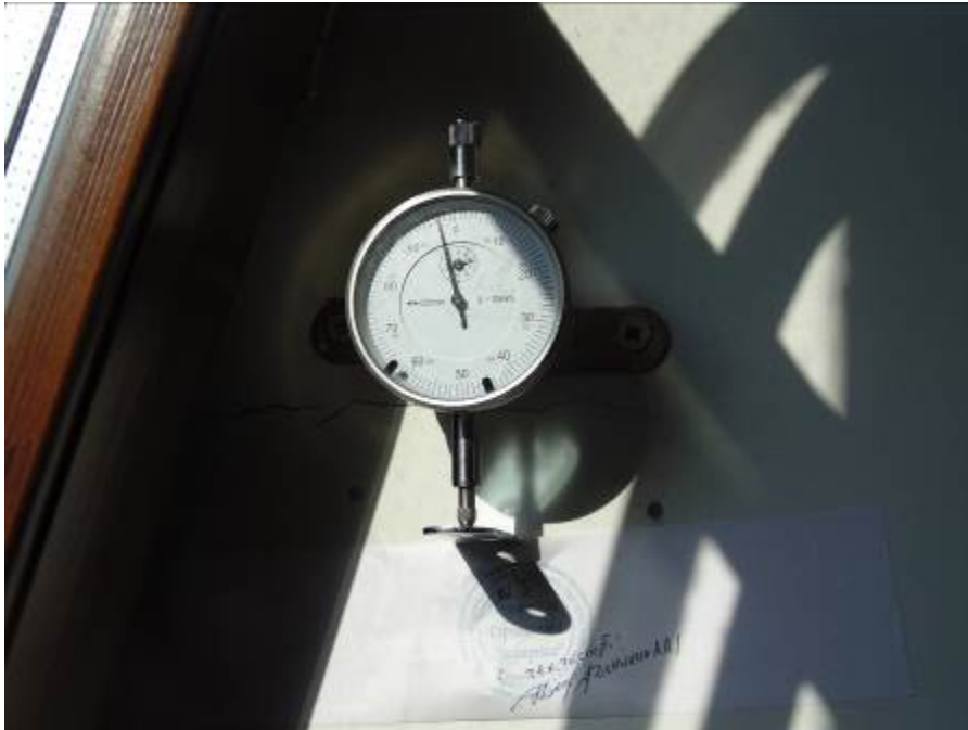
Фото 5. Фотофиксация показаний маяка (индикатора-щелемера) (замер 3) _____г.
