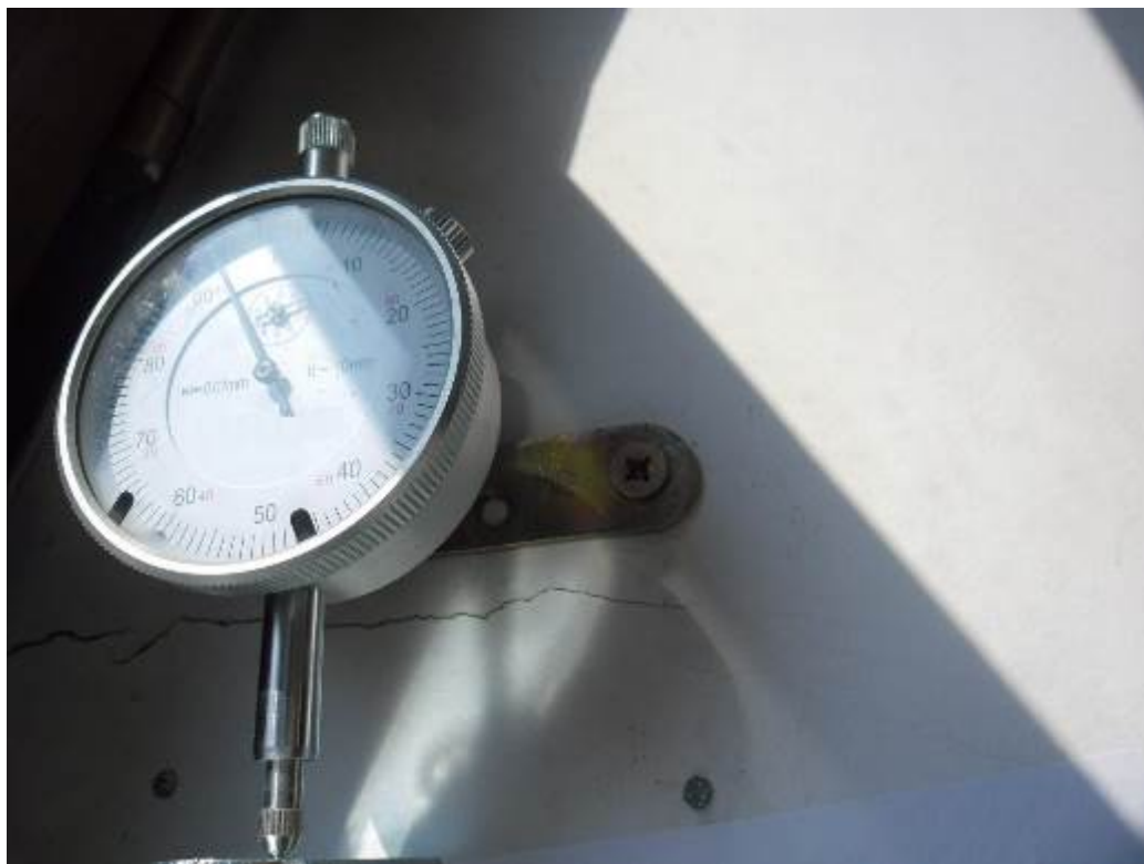
Фото 10. Фотофиксация показаний маяка (индикатора-щелемера) (замер 5) _____Г.
