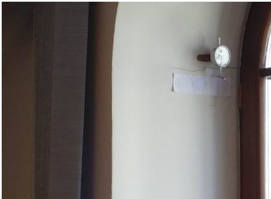
Фото 1. Установленный маяк (индикатор-щелемер) на трещину, проходящую по откосу оконного проема в помещении мансардного этажа здания (замер 1) _____ г.
