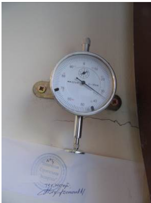
Фото 3. Установленный маяк (индикатор-щелемер) на трещину, проходящую по откосу оконного проема в помещении мансардного этажа здания (замер 2) _____ г.
