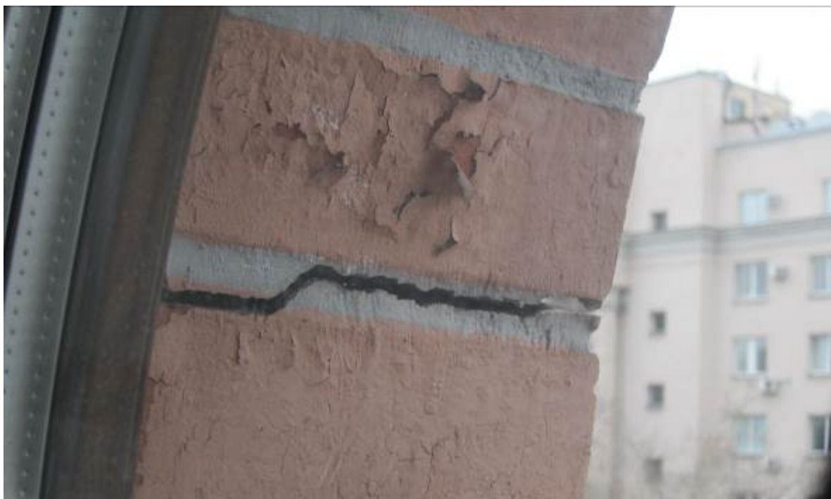
Фото 8. Фотофиксация показаний маяка (индикатора-щелемера) (замер 4) _____ Г.
