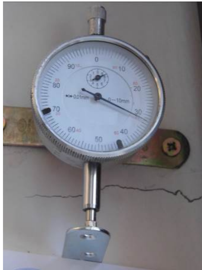
Фото 6. Фотофиксация показаний маяка (индикатора-щелемера) (замер 3) _____г.
