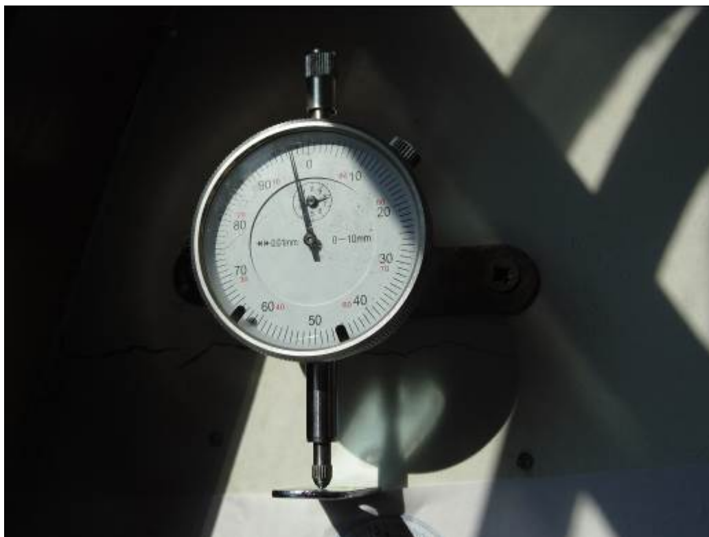
Фото 9. Фотофиксация показаний маяка (индикатора-щелемера) (замер 5) _____Г.
