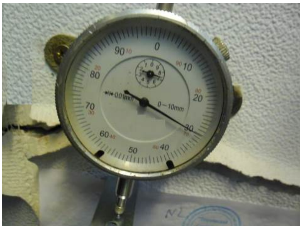
Фото 2. Установленный маяк на трещину, проходящую по наружной стене под оконным проемом (замер 1) _____ г.
