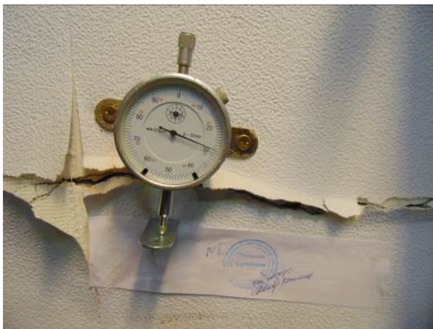
Фото 4. Установленный маяк (индикатор-щелемер) на трещину, проходящую по откосу оконного проема в помещении мансардного этажа здания (замер 2) _____ г.
