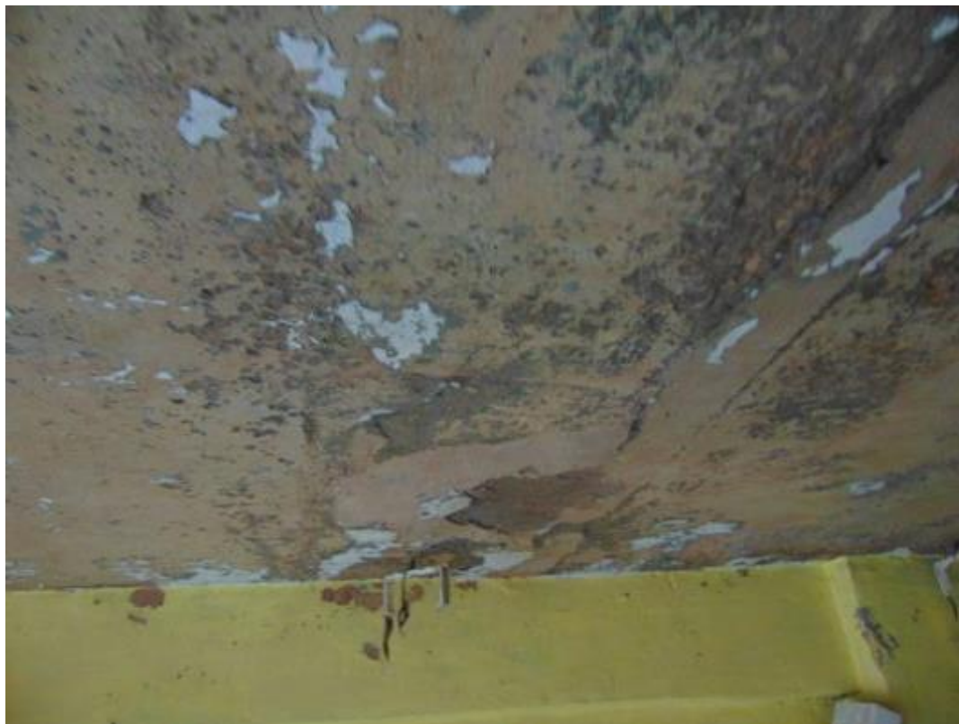
Фото 12. Плиты покрытия бокса. Выявлены множественные разрушения отделочного покрытия. Выявлены трещины по швам между плитами покрытия. Разрушений и деформаций самих плит покрытия не выявлено.
