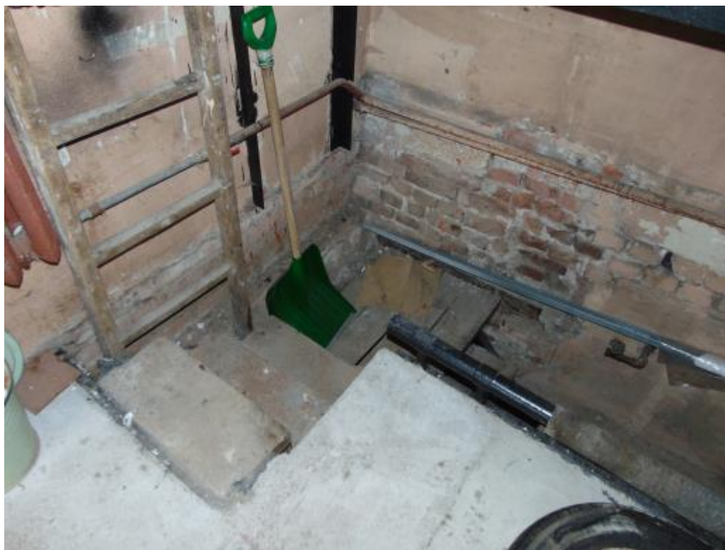
Фото 18. Отделочное покрытие стен. Штукатурное покрытие отслаивается большими массивами.
