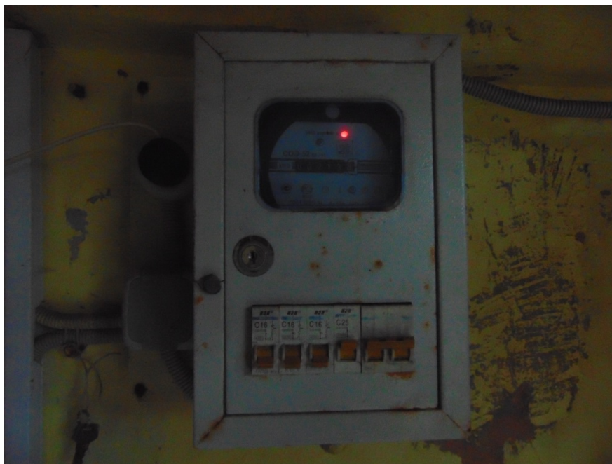
Фото 26. Электроснабжение бокса. Электрощит находится в рабочем состоянии.
