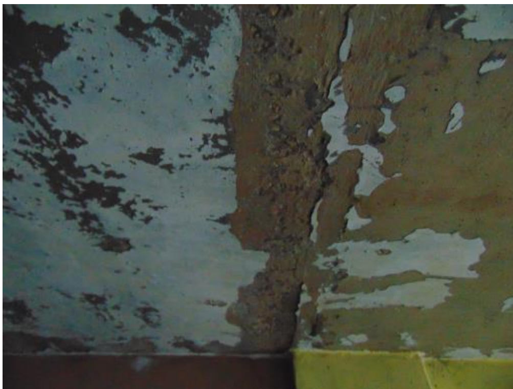
Фото 21. Окрасочное покрытие потолков. Окрасочное покрытие повреждено и отслаивается по всей площади потолков.
