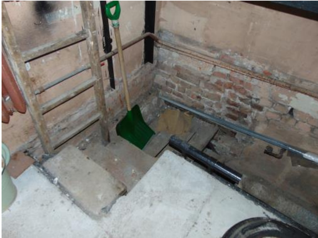
Фото 1. Подвал. Выявлено разрушение штукатурного покрытия на поверхности фундаментных стен. Разрушений и деформаций конструкции фундаментов не выявлено.
