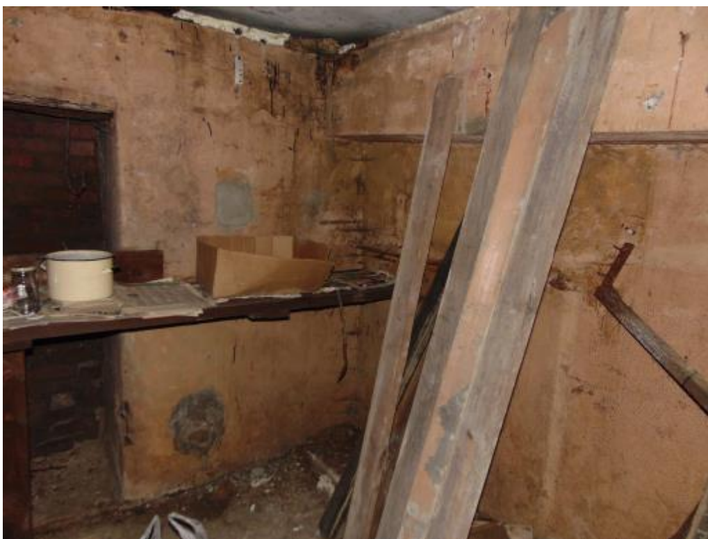
Фото 23. Отделочное покрытие стен. Штукатурное покрытие покрыто трещинами по всей площади стен.
