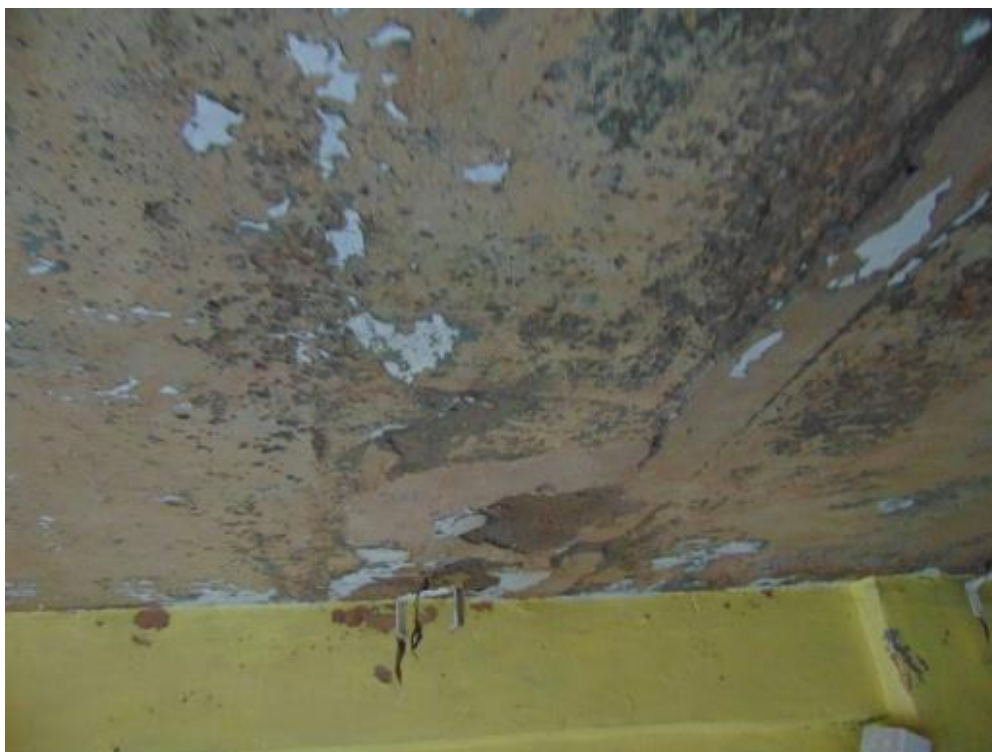
Фото 20. Окрасочное покрытие потолков. Окрасочное покрытие повреждено и отслаивается по всей площади потолков.
