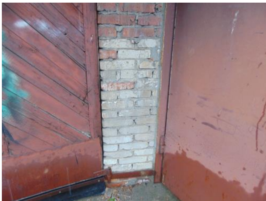
Фото 6. Наружные стены. Имеются неглубокие трещины и выветривание швов кирпичной кладки.
