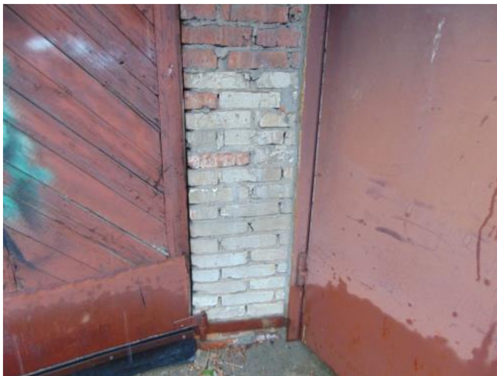
Фото 3. Цокольная часть наружных стен. Повреждений, свидетельствующих о разрушении и деформации фундаментов, не выявлено.
