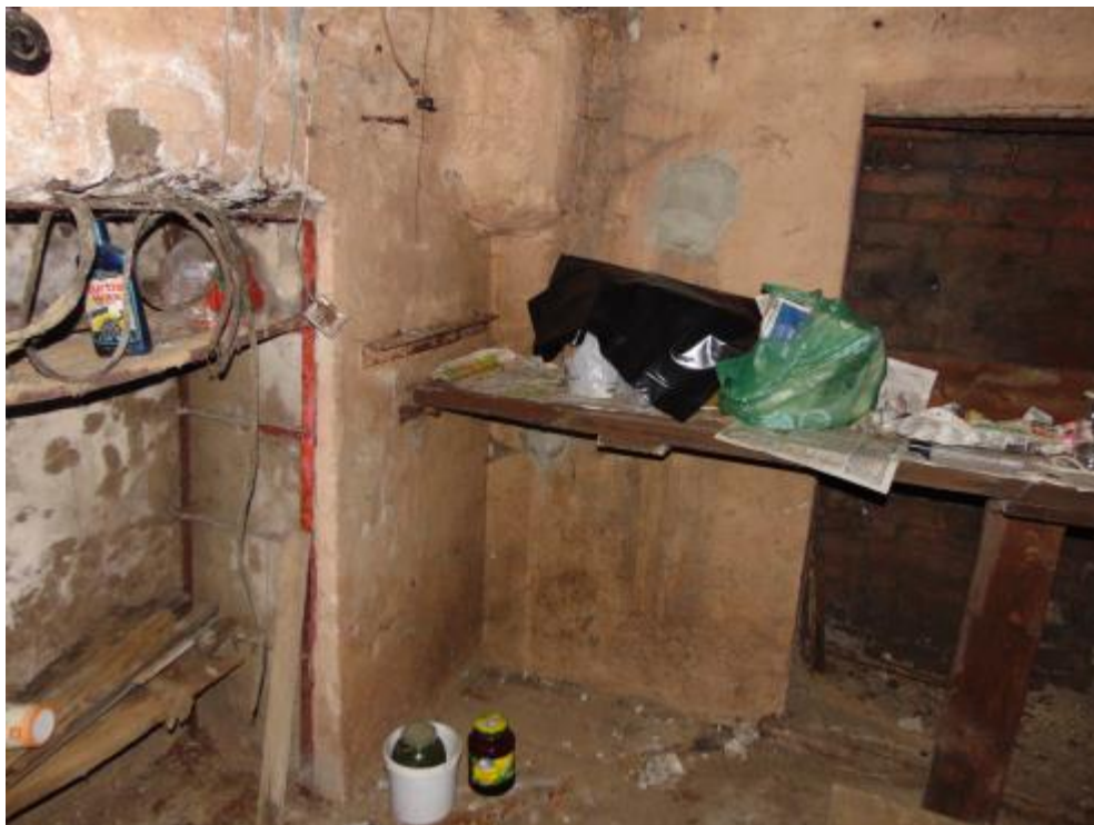
Фото 2. Подвал. На поверхности фундаментных стен имеются множественные повреждения и отслоения штукатурного покрытия. Разрушений и деформаций конструкции фундаментов не выявлено.
