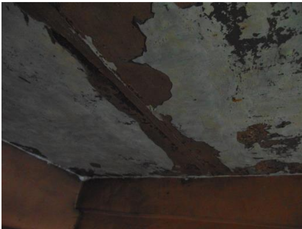
Фото 22. Окрасочное покрытие потолков. Окрасочное покрытие повреждено и отслаивается по всей площади потолков.
