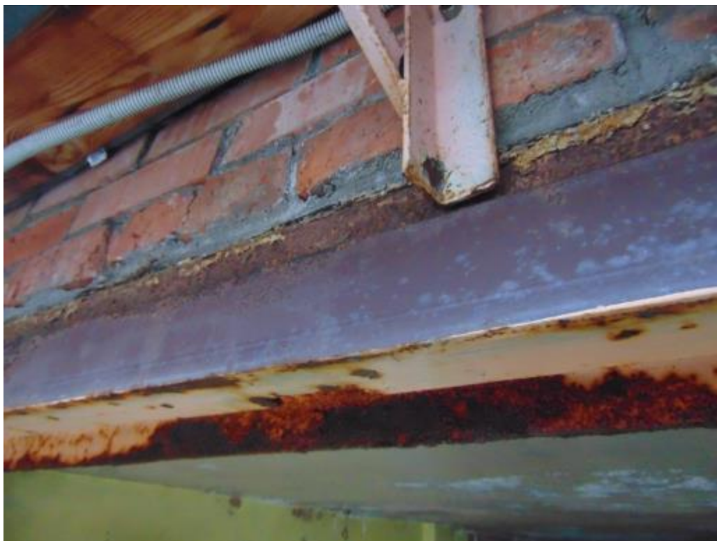
Фото 19. Окрасочное покрытие металлических конструкций. Полное разрушение окрасочного покрытия.
