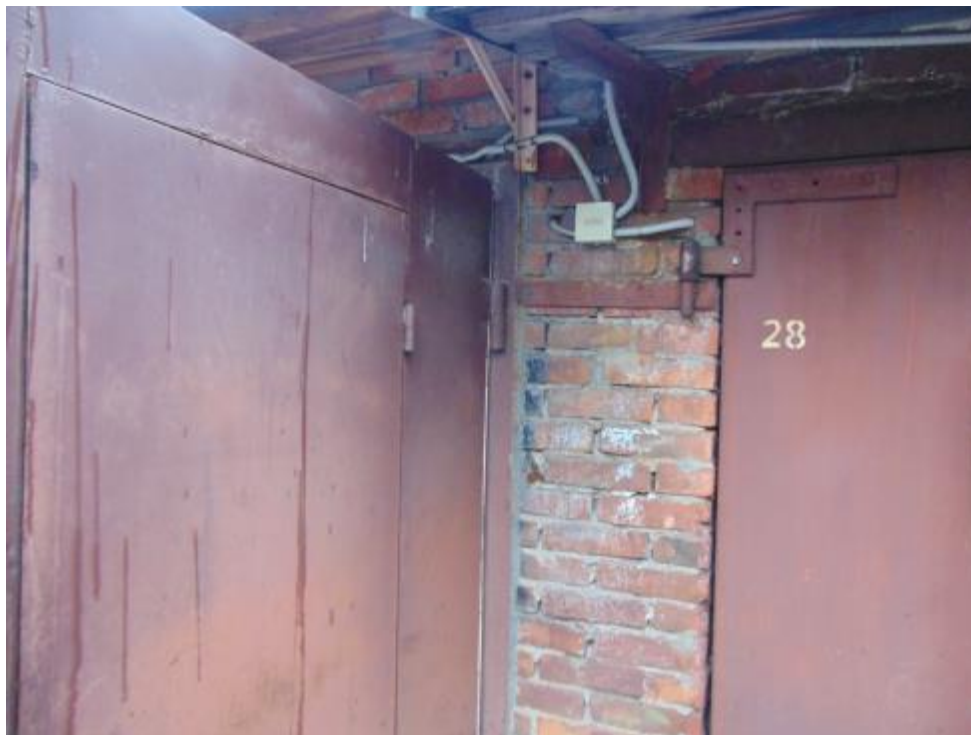
Фото 5. Наружные стены. Имеются неглубокие трещины и выветривание швов кирпичной кладки.
