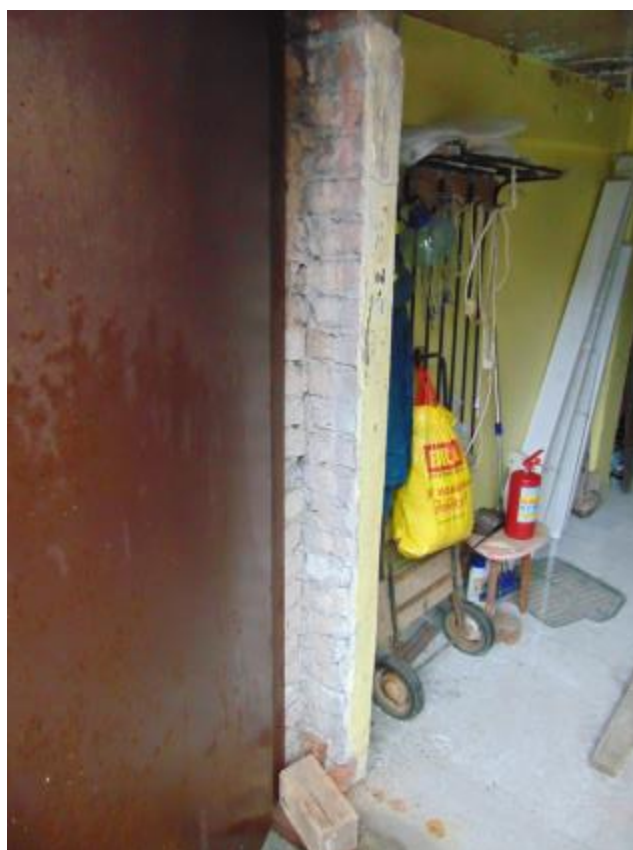
Фото 8. Наружные и внутренние стены. Имеются неглубокие трещины и выветривание швов кирпичной кладки.
