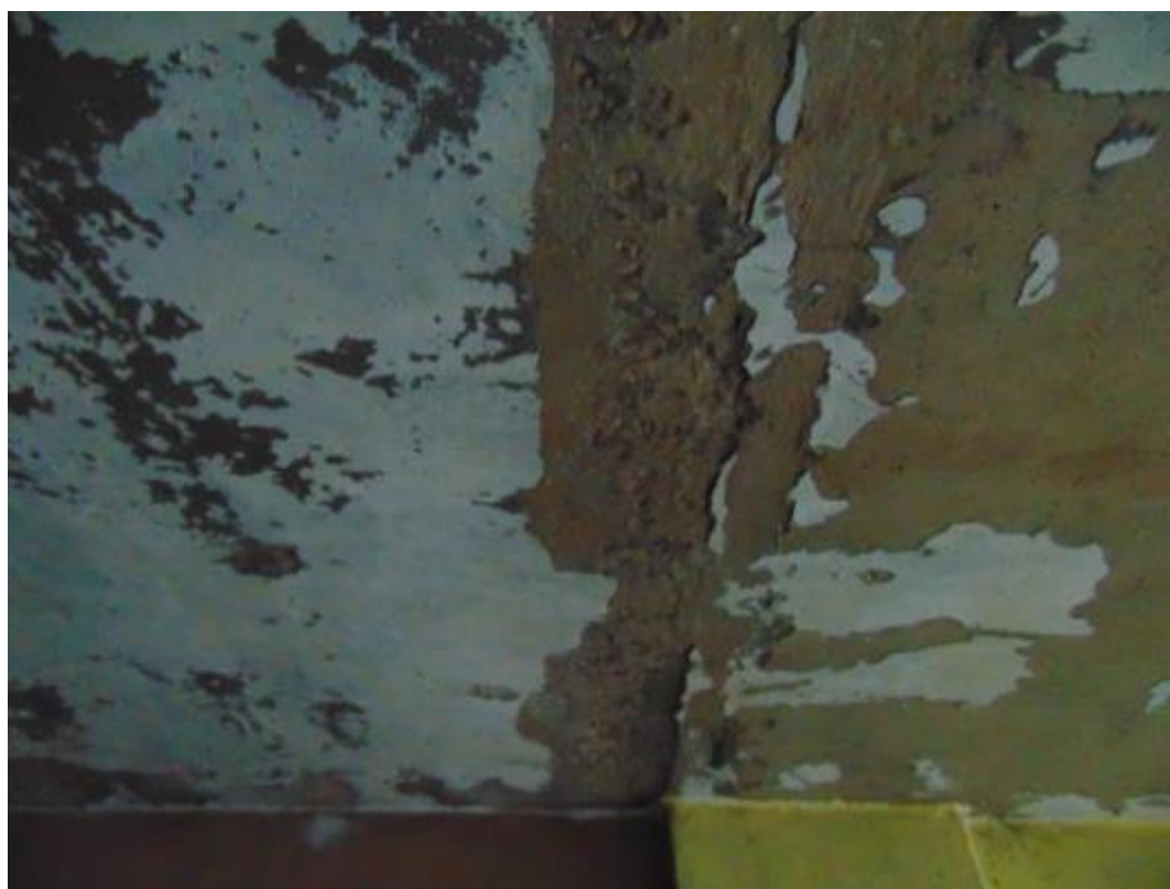
Фото 13. Плиты покрытия бокса. Выявлены множественные разрушения отделочного покрытия. Выявлены трещины по швам между плитами покрытия. Разрушений и деформаций самих плит покрытия не выявлено.
