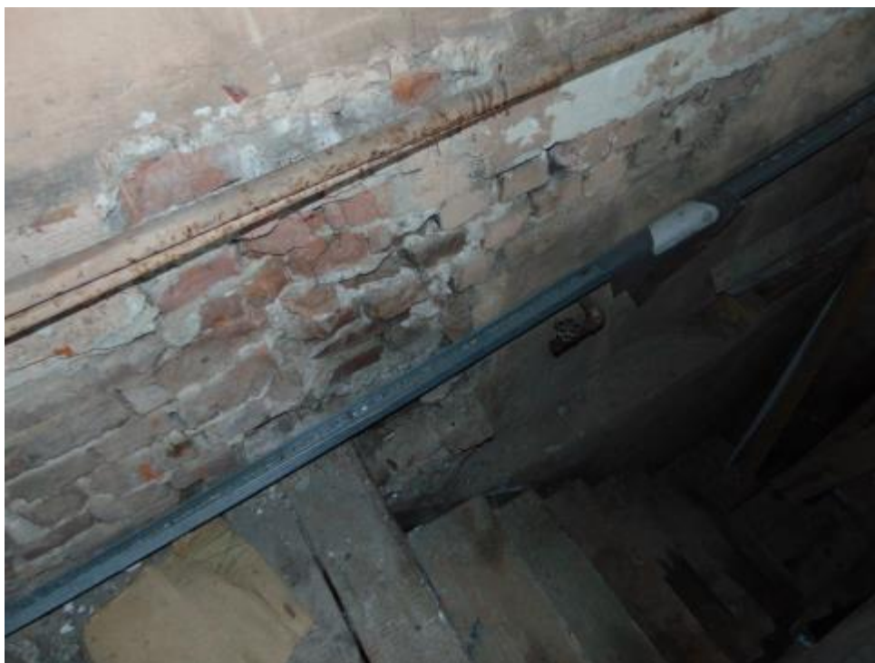
Фото 7. Внутренние стены. Выявлены участки разрушения поверхности кирпичной кладки в следствии механического воздействия. Также, выявлены неглубокие трещины по швам кирпичной кладки.
