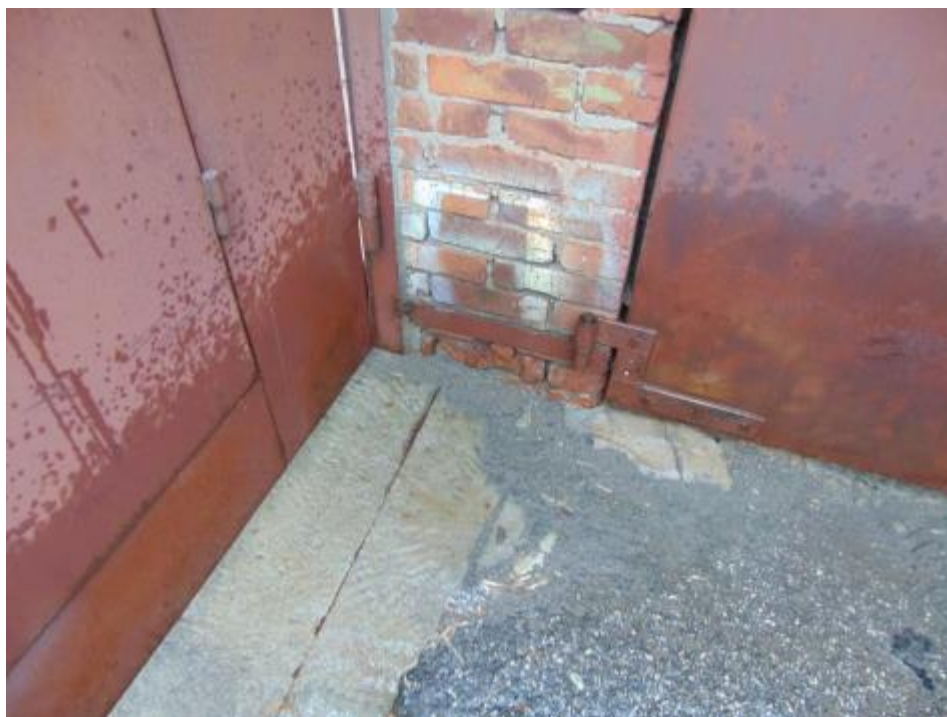
Фото 9. Наружные стены. Имеются неглубокие трещины и выветривание швов кирпичной кладки. Также, выявлено разрушение поверхности кирпичной кладки у поверхности земли в следствии воздействия избыточной влажности и сезонных температурных перепадов.
