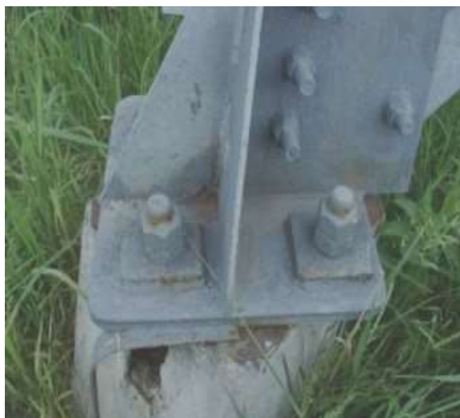
Фото 5. Разрушение АКЗ, опора № 44
