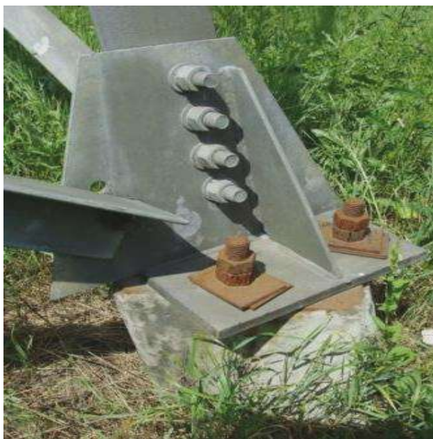
Фото 6. Отсутствие АКЗ анкерного крепления , опора № 32
