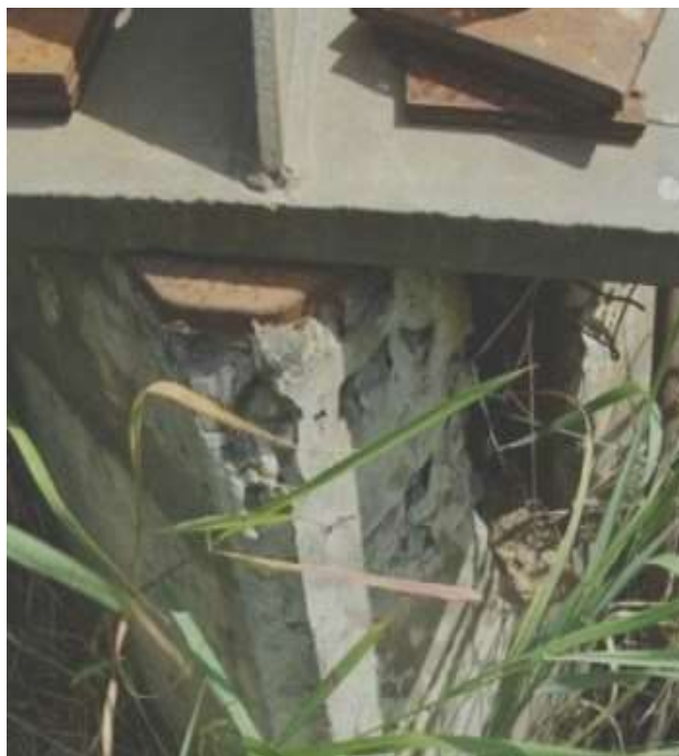
Фото 7. Раковины в бетоне фундамента, опора № 32
