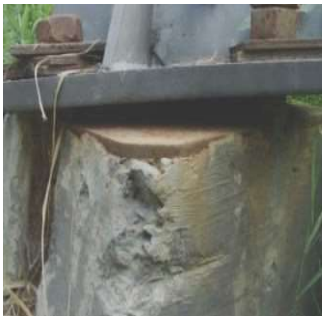
Фото 4. Раковины в бетоне фундамента, не плотное прилегание пяты к опорной площадке опора № 33
