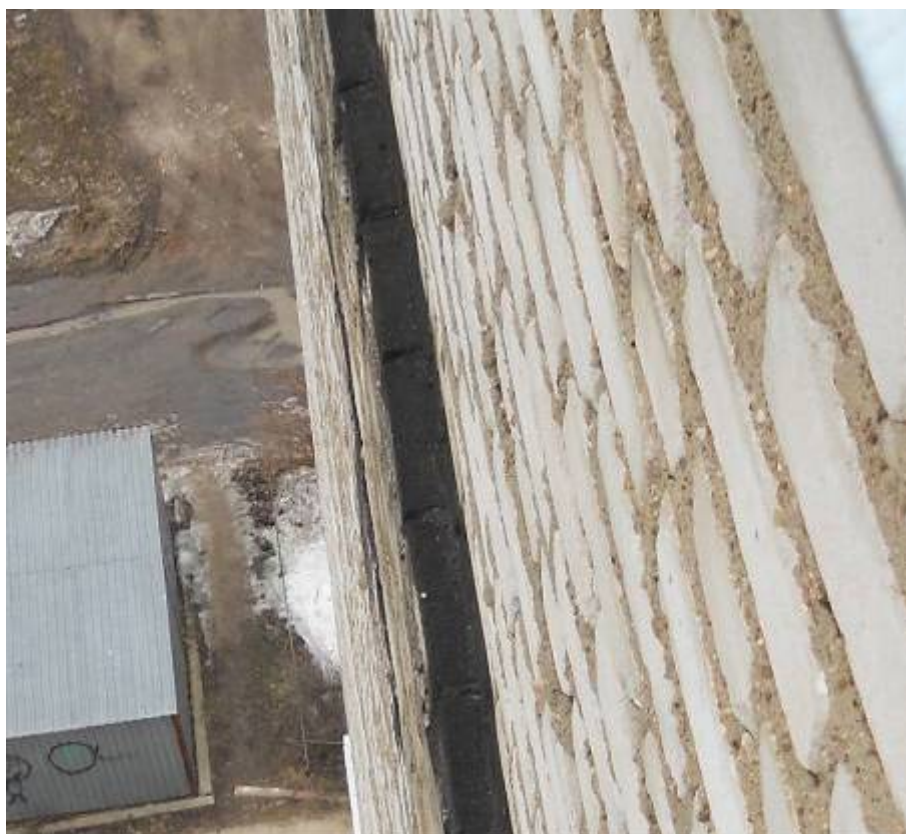
№4. Дефекты кирпичной кладки, не устраненные после герметизации швов
