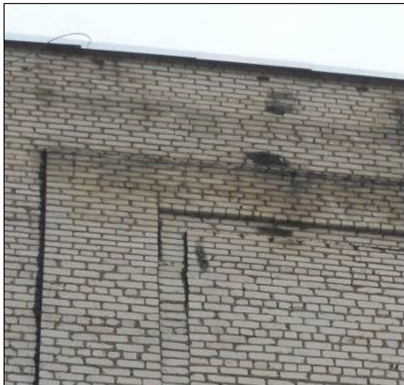
№3. Техническое состояние торцевой стены кв. ___
