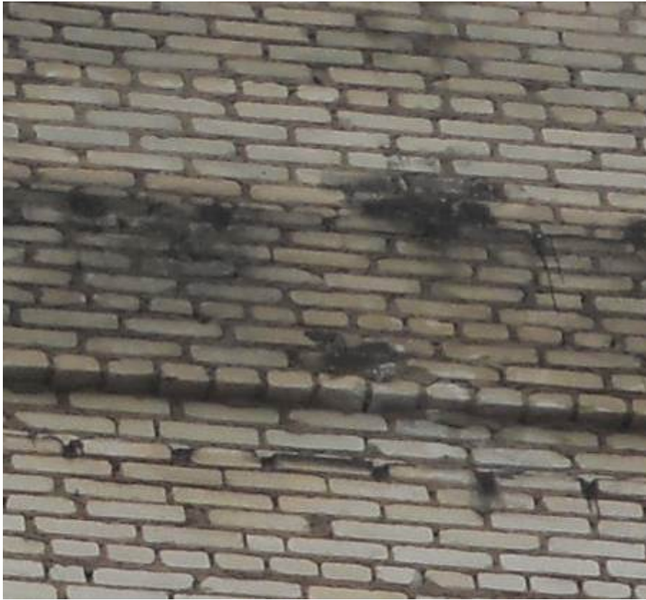
№5. Дефекты швов кирпичной кладки, ведущие к замачиванию стены
