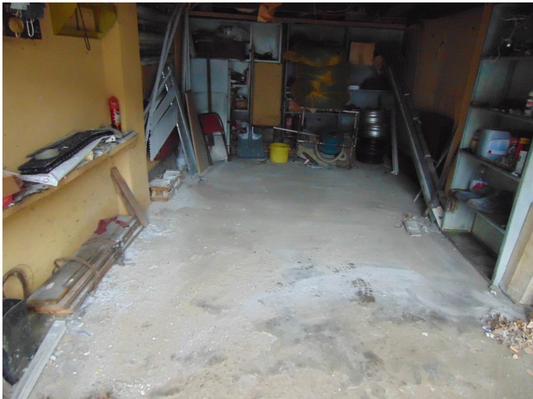
Фото 10. Полы. Выявлены множественные выбоины, отслоения и стертости.
