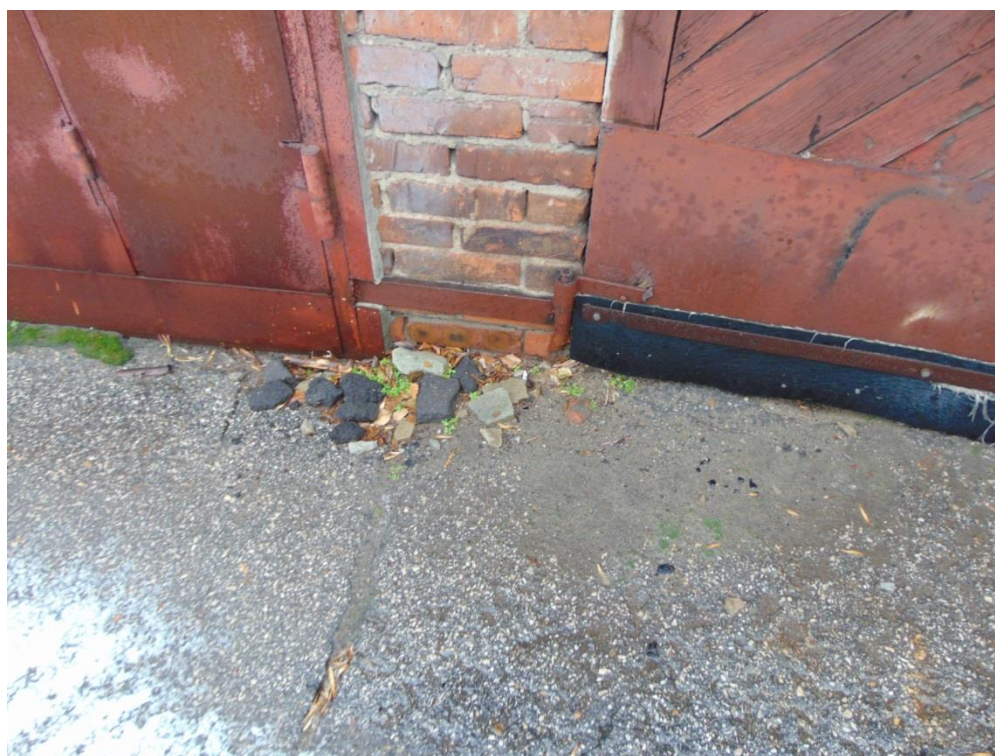
Фото 7. Наружные стены. Имеются трещины и последствия выветривания раствора из швов кирпичной кладки.
