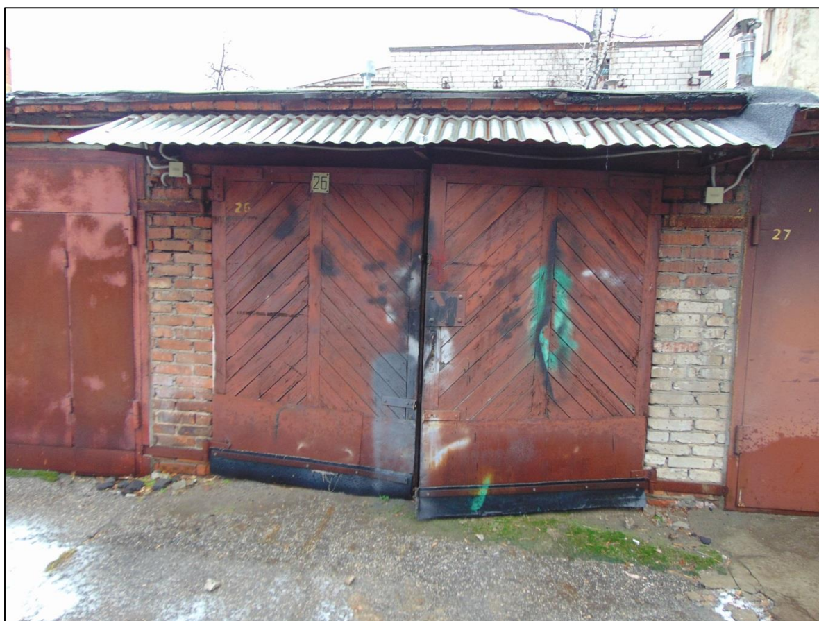
Фото 24. Въездные ворота. Выявлены щели между планками деревянных щитов створок ворот. Просадок полотен не выявлено.
