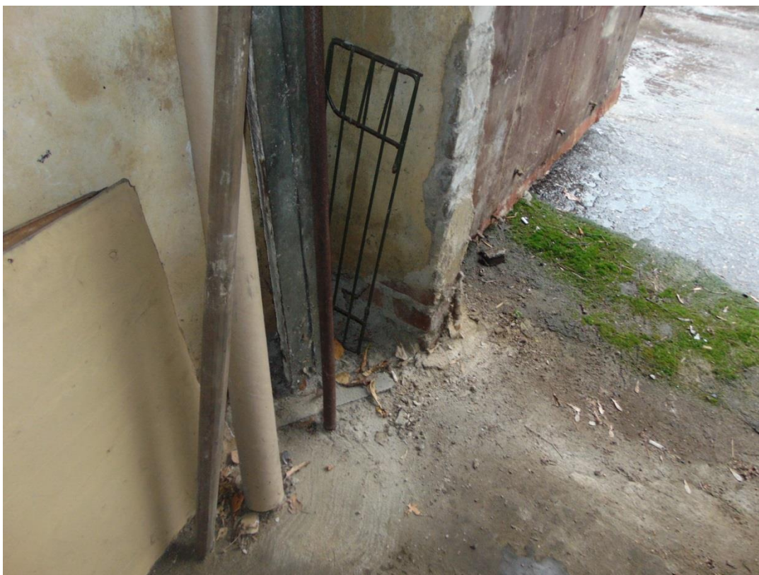
Фото 20. Отделочное покрытие стен. Штукатурное и окрасочное покрытие отслаивается большими массивами..
