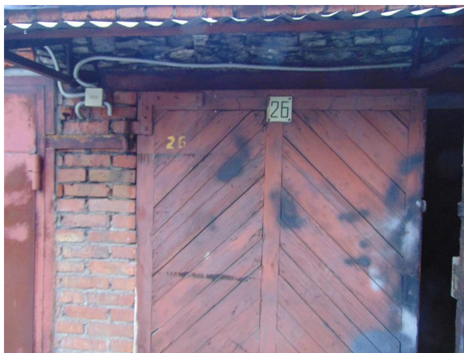
Фото 5. Наружные стены. Имеются трещины и последствия выветривания раствора из швов кирпичной кладки.
