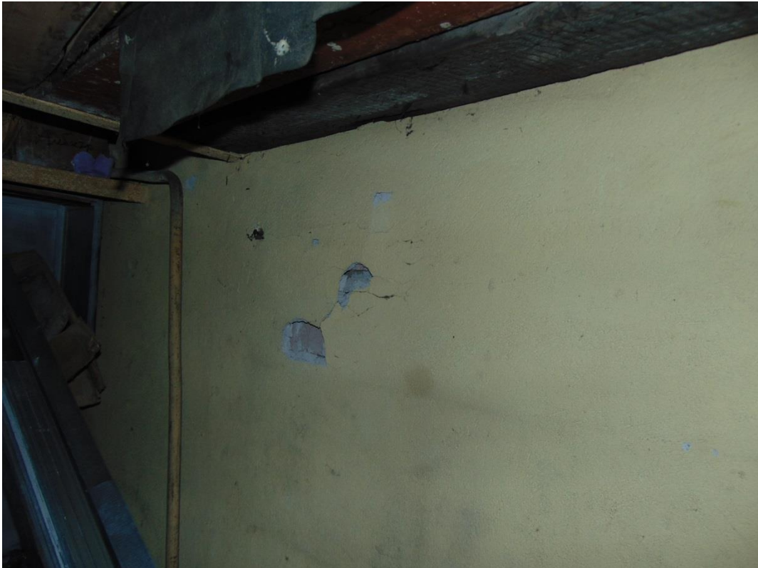
Фото 18. Отделочное покрытие стен. Штукатурное и окрасочное покрытие отслаивается большими массивами.
