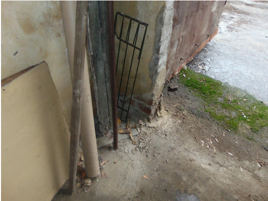
Фото 8. Наружные и внутренние стены. Выявлены обширные поврежденные участки отделочного покрытия стен. Выявлены трещины и последствия выветривания раствора из швов кирпичной кладки.
