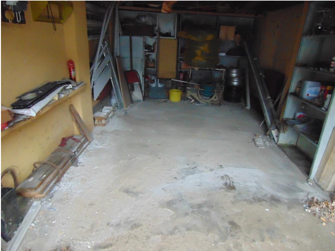
Фото 27. Электрические коммуникации бокса. Дефектов и повреждений электрических кабелей не выявлено.
