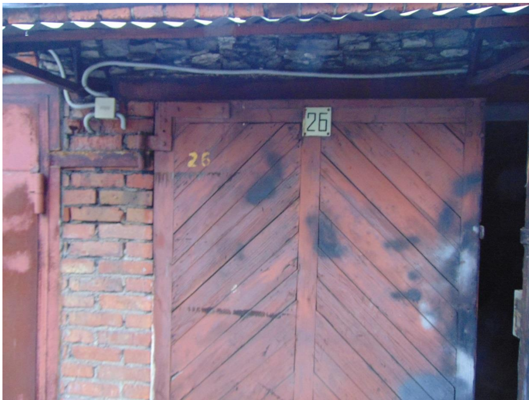
Фото 25. Въездные ворота. Выявлены щели между планками деревянных щитов створок ворот. Просадок полотен не выявлено.
