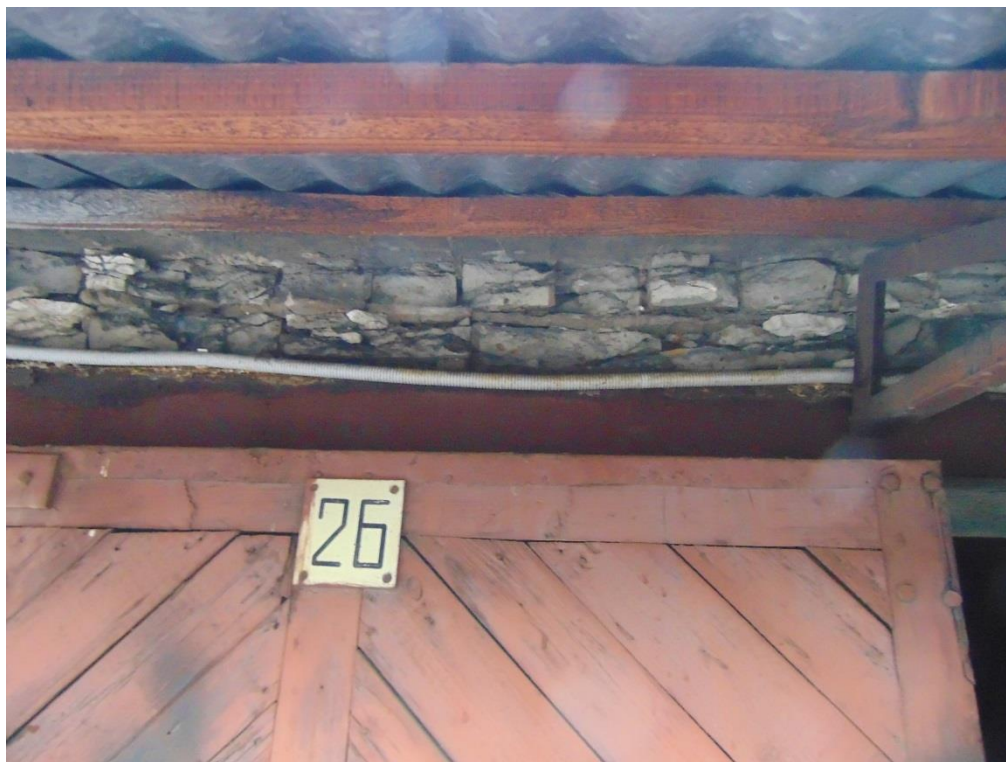
Фото 6. Наружные стены. Выявлено разрушение кирпичной кладки над перемычкой проема въездных ворот.
