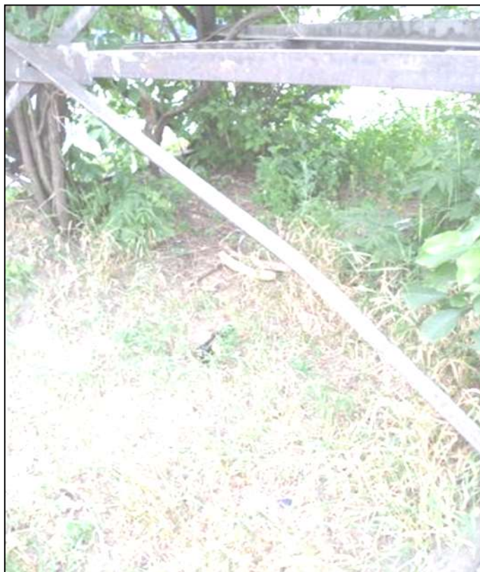
Фото 3. Опора № 30. Деформация раскоса решетки более 20 мм.
