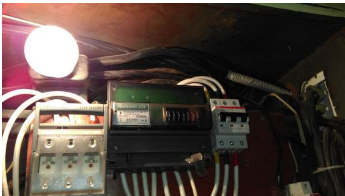
Фото 6. Расположение электрооборудования в щитке. Питающий кабель.
