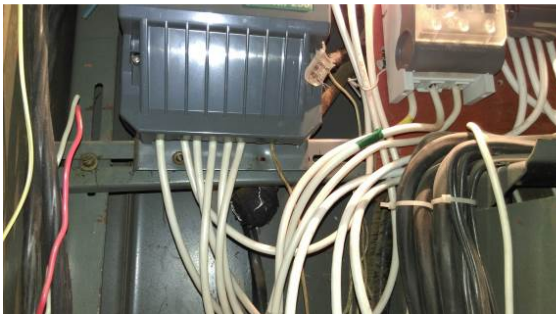
Фото 5. Расположение электрооборудования в щитке. Питающий кабель.
