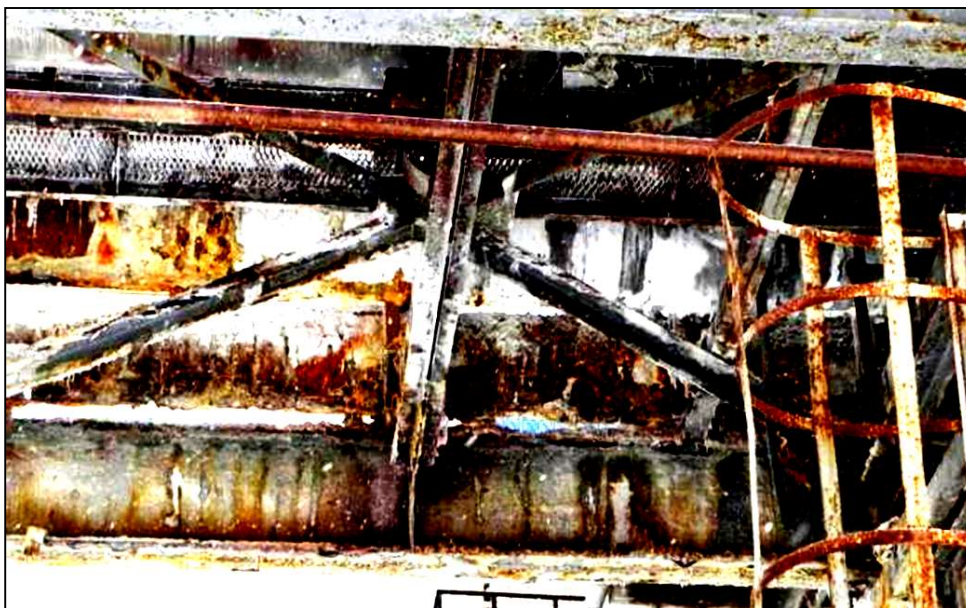
Фото 14. Металлические конструкции (опора, ригели, связи, траверсы) в осях «В-Г/56-57», подвержены воздействию хим. составами, транспортируемыми по трубопроводам. Разрушение антикоррозионной защиты, химическая коррозия металла.
