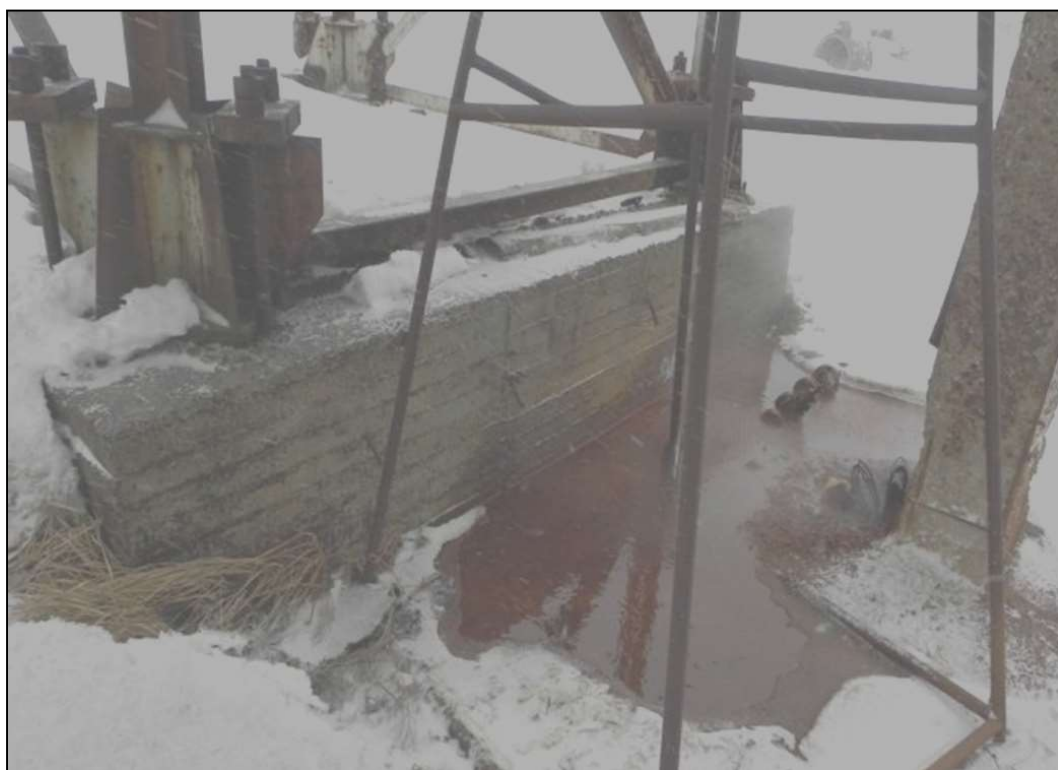
Фото 21. Металлическая опора в осях «В-Г/113-114». Образование луж воды около фундамента опоры. Увлажнение фундамента. Разрушение антикоррозионной защиты. Поверхностная коррозия металла.
