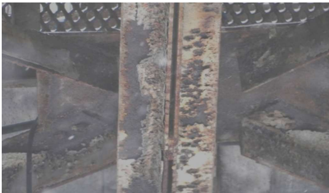
Фото 13. Металлические конструкции в отм. 6,500-8,300м по всей длине эстакады. Разрушение антикоррозионной защиты до грунтовки.
