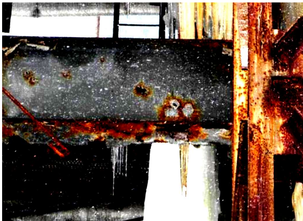
Фото 11. Отслаивание антикоррозионного покрытия. Питтинговая и язвенная коррозия металла опоры и ригелей.
