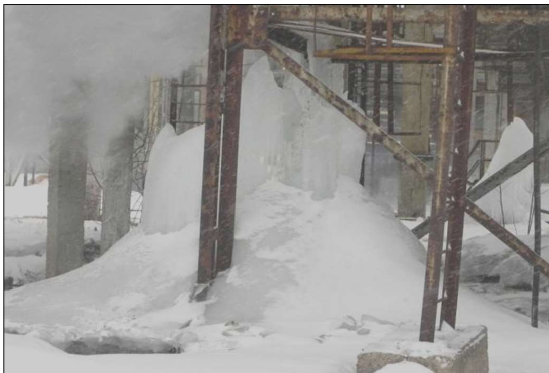
Фото 19. Металлическая опора в осях «В-Г/89-90». Образование луж воды около фундамента опоры. Увлажнение и обмерзание металлических конструкций. Разрушение антикоррозионной защиты. Поверхностная коррозия металла.
