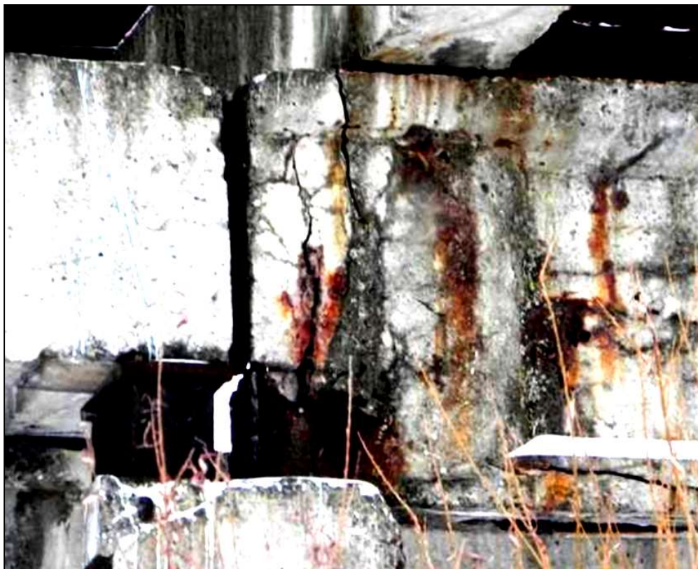
Фото 2. Трещины в опорной зоне двутаврового ригеля в осях «В/5-6».
