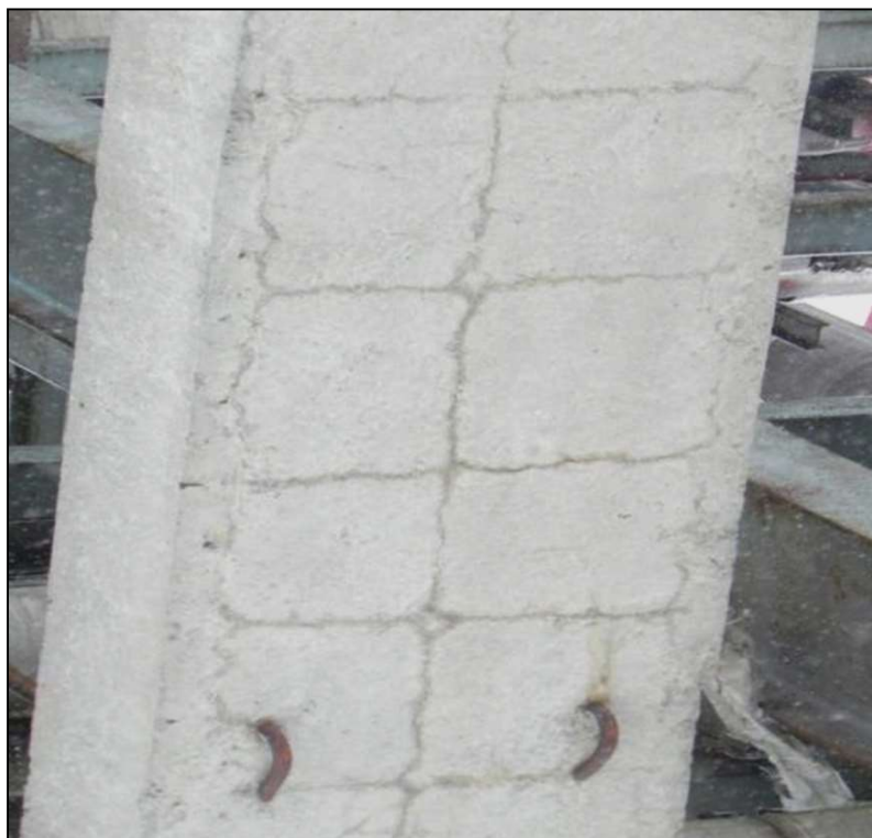
Фото 15. Продольные и поперечные усадочные трещины вдоль арматурных стержней колонны из-за несоблюдения толщины защитного слоя бетона. Проникновение влаги в тело бетона.
