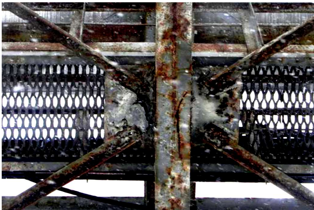
Фото 12. Отслаивание антикоррозионного покрытия. Питтинговая и язвенная коррозия металлической фермы.
