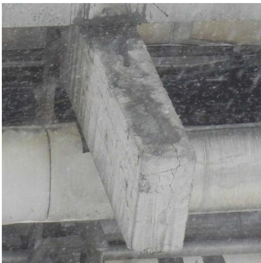
Фото 25. Балка прямоугольного сечения в осях «В-Г/97-98». Растрескивание бетона консоли. Трещины шириной раскрытия 0,6 мм.
