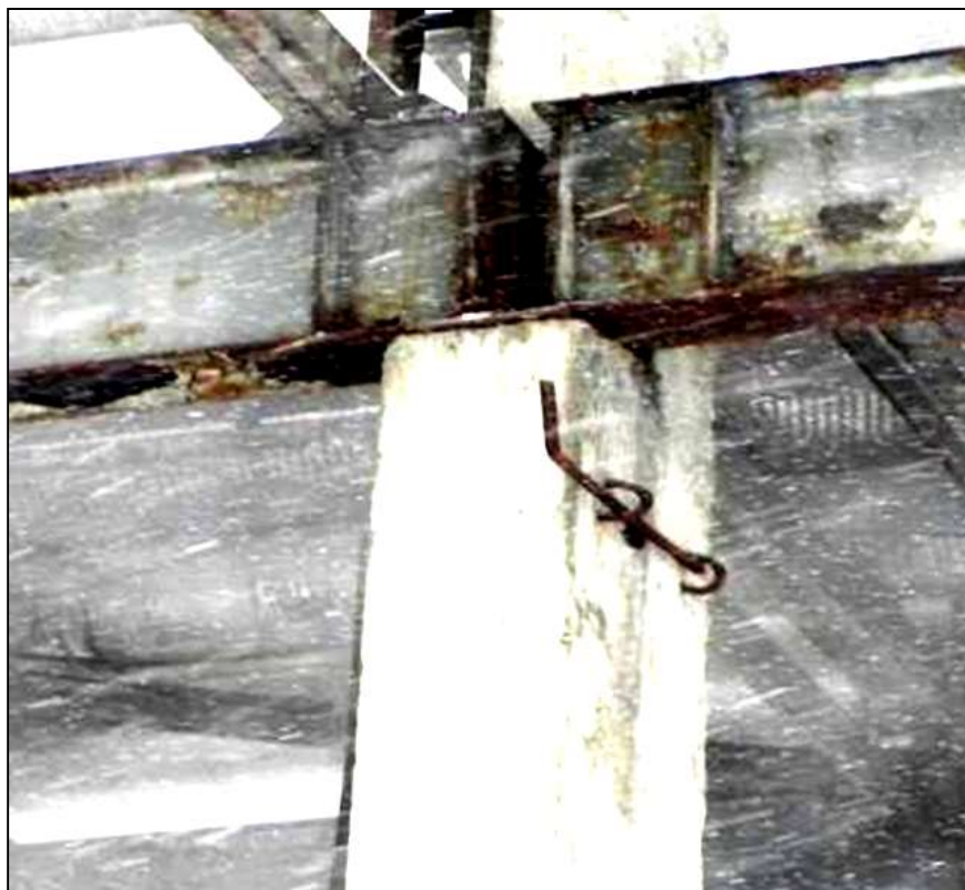
Фото 10. Двухступенчатая колонна К2 в осях «В/46». Продольные трещины шириной раскрытия \delta = 0,6 мм и протяженностью до 100 мм.
