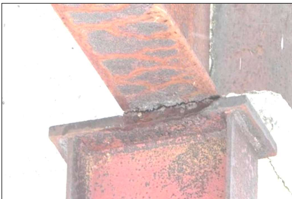
Фото 1. Разрушение шва сварного соединения ригеля и опорного столика.
