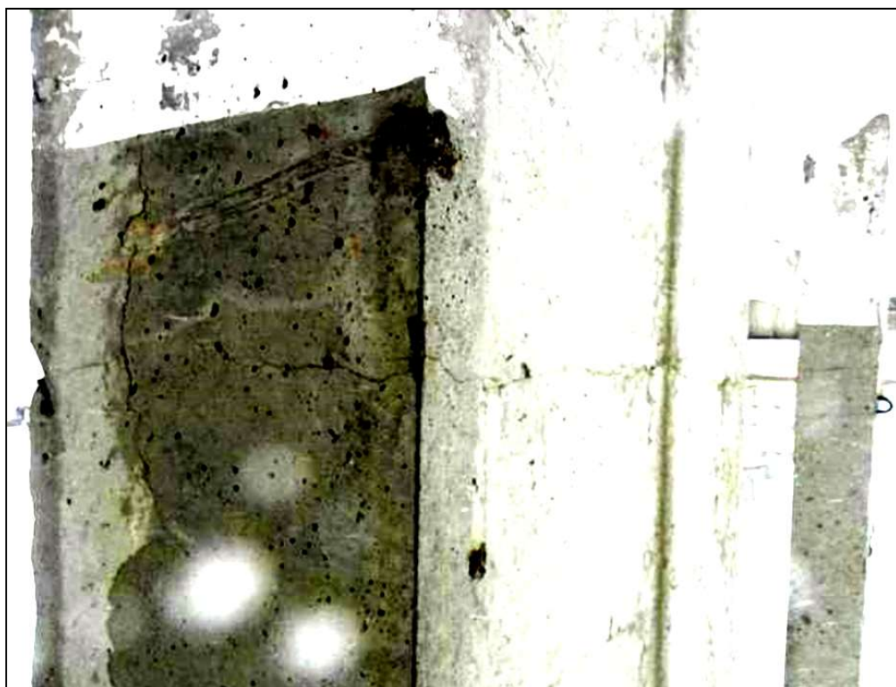
Фото 17. Продольные и поперечные трещины вдоль арматурных стержней колонны, возникшие из-за несоблюдения толщины защитного слоя бетона.
