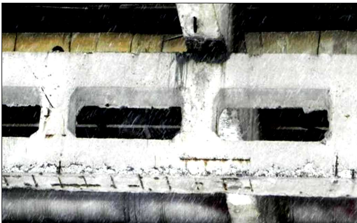
Фото 23. Отстрел бетона. Несоблюдение толщины защитного слоя. Коррозия арматуры решетчатой балки.
