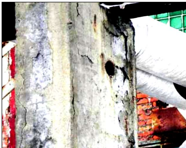
Фото 8. Двухступенчатая колонна К2 в осях «Г/36». Продольные трещины шириной раскрытия до 0,7 мм, лещадки, растрескивание опорной зоны металлического ригеля.
