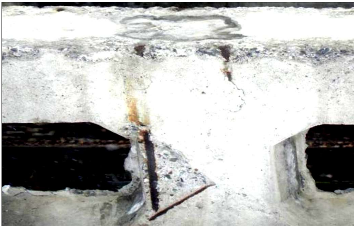
Фото 22. Несоблюдение толщины защитного слоя бетона. Оголение и коррозия арматуры решетчатой балки. Отстрел бетона из-за коррозии арматуры.
