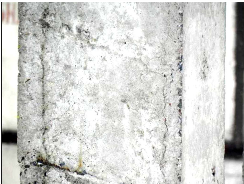
Фото 4. Продольная трещина шириной раскрытия \delta=0,2 мм и протяженностью l=100 мм в прямоугольной колонне К1.
