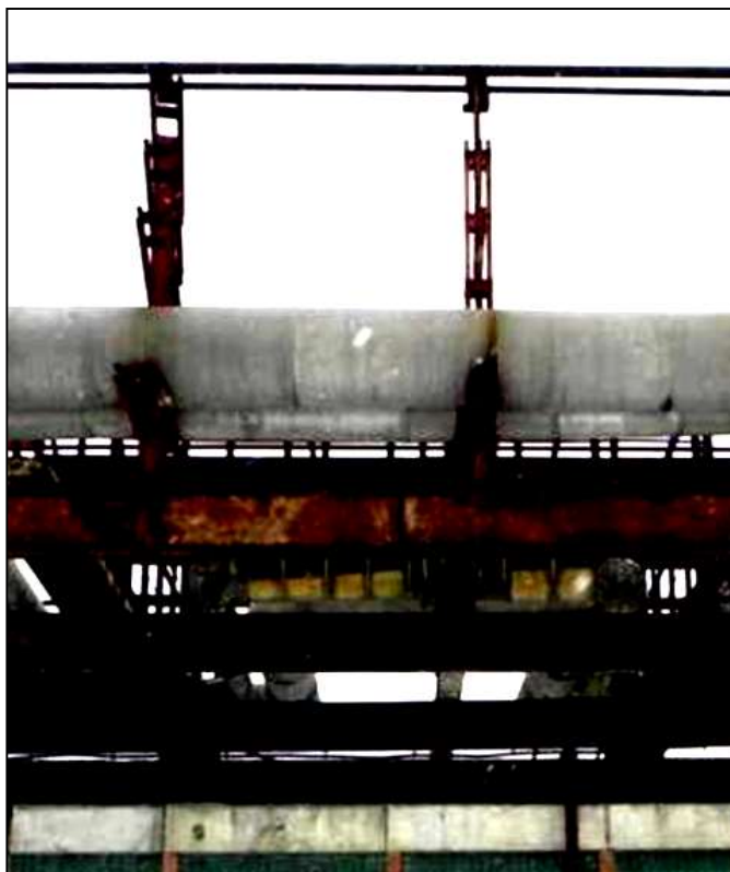
Фото 6. Компенсатор в осях «А-Г/22-23». Отсутствует антикоррозионная защита металлических конструкций (ригели, балки, траверсы).
