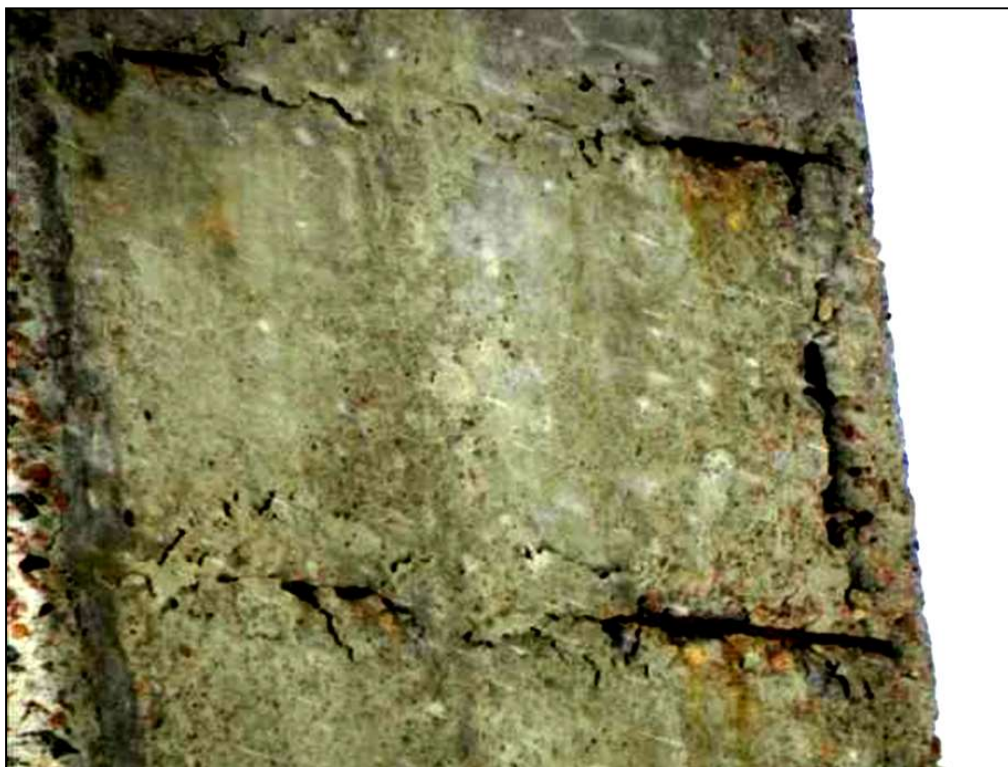
Фото 16. Отстрел бетона в результате несоблюдения толщины защитного слоя, проникновения влаги и коррозии арматурных стержней.
