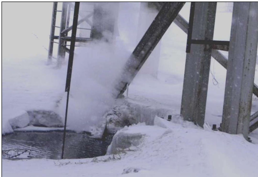
Фото 18. Металлическая опора в осях «В-Г/75-76». Образование луж воды около фундамента опоры.
