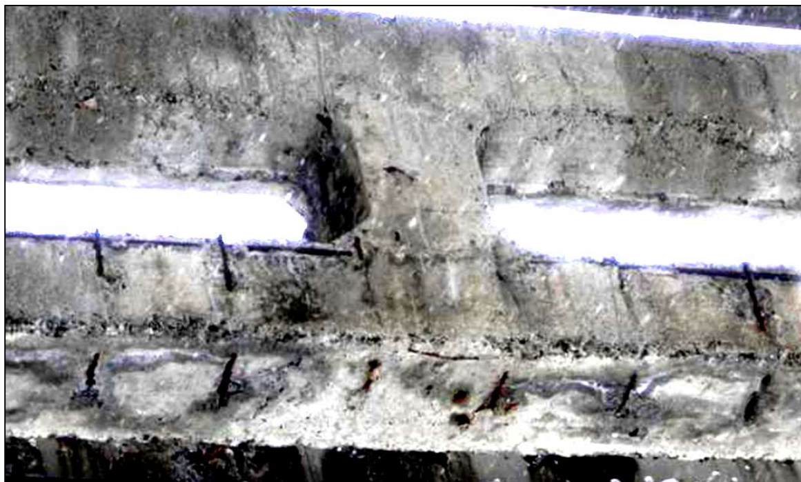
Фото 24. Отстрел бетона. Несоблюдение толщины защитного слоя. Коррозия арматуры решетчатой балки.
