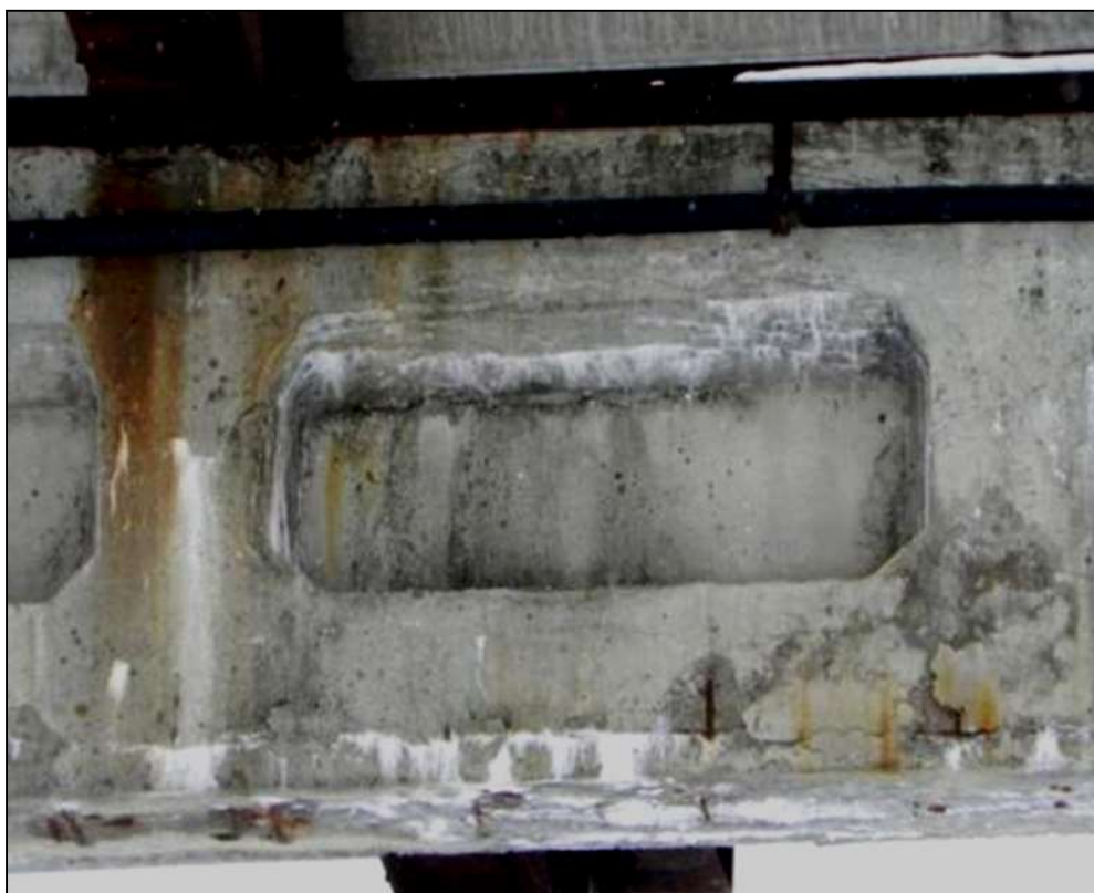
Фото 5. Несоблюдение защитного слоя бетона, коррозия арматуры, продольные трещина, выщелачивание решетчатого ригеля в осях «В/21-22».
