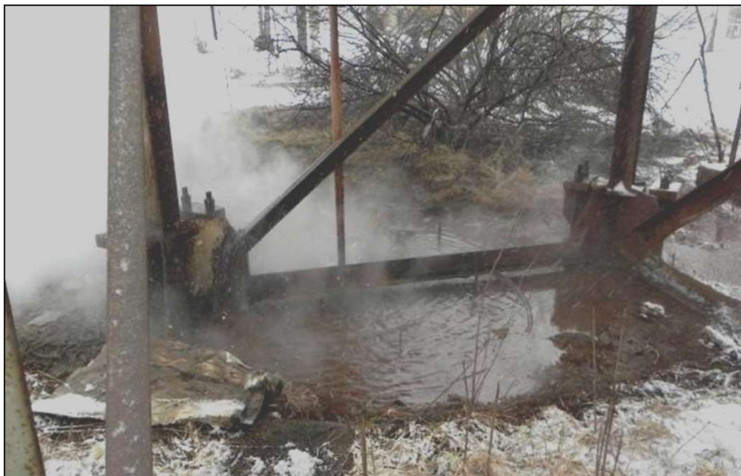
Фото 20. Металлическая опора в осях «В-Г/111-112». Образование луж воды около фундамента опоры. Увлажнение и обмерзание металлических конструкций. Разрушение антикоррозионной защиты. Поверхностная коррозия металла.
