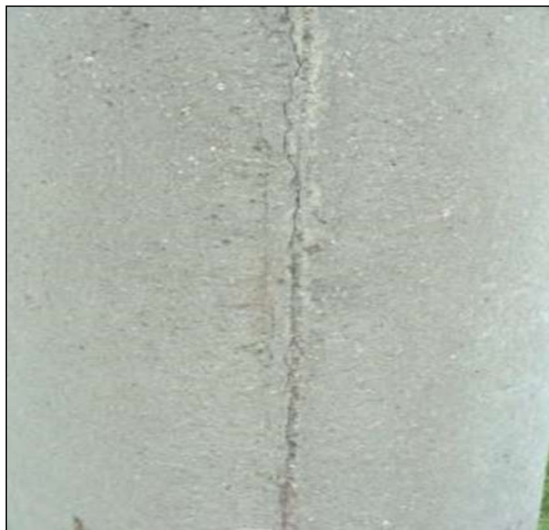
Фото 4. Опора № 6. Продольная трещина шириной более 0,6мм, длиной до 1,5м.
