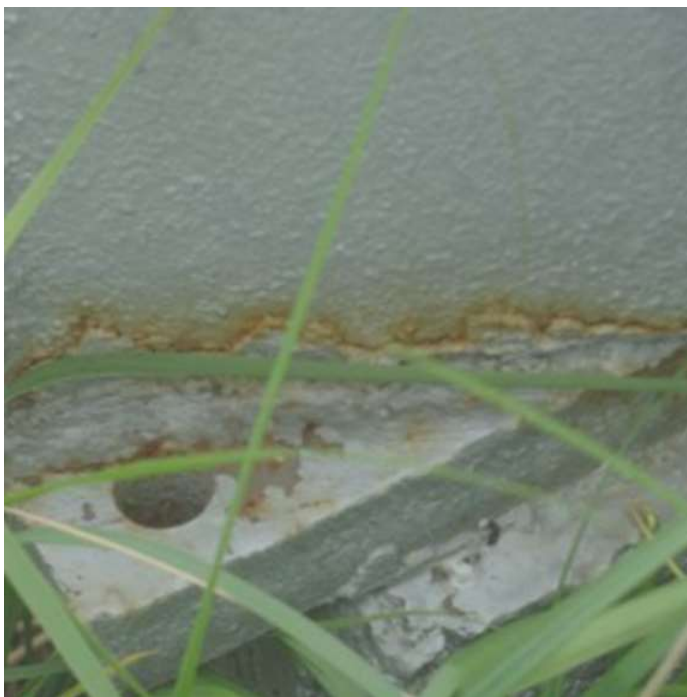
Фото 7. Опора № 2. Внутренняя коррозия сварного шва.
