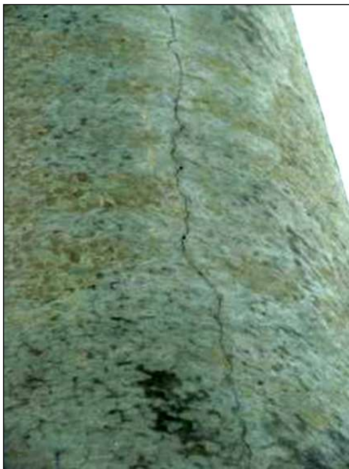
Фото 2. Опора № 6. Продольная трещина шириной до 0,6мм, длиной до 4м.
