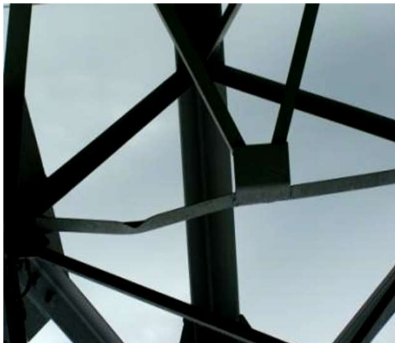
Фото 9. Опора № 5. Деформация раскоса решетки.
