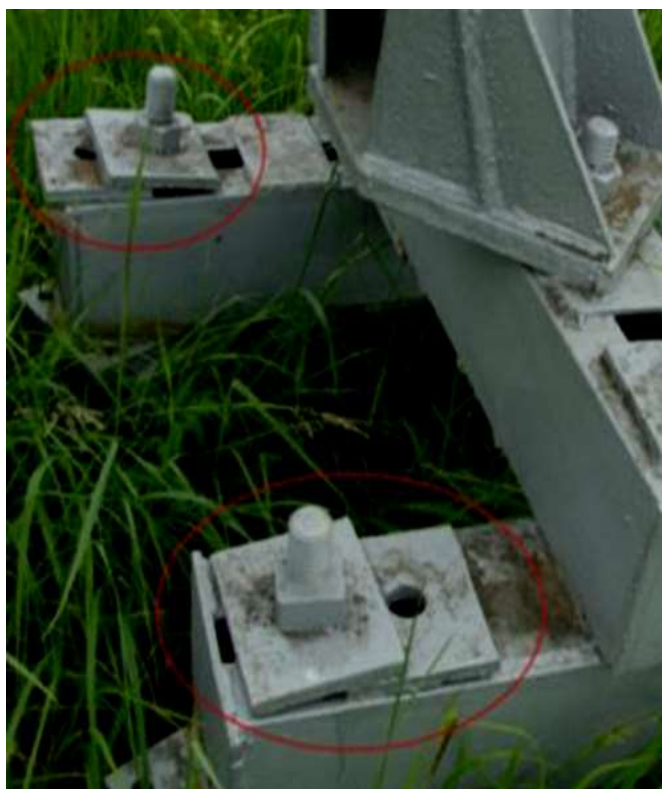
Фото 6. Опора № 2. Шайбы не имеют надежной фиксации.
