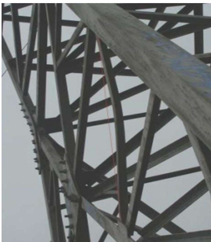
Фото 8. Опора № 4. Деформация раскоса решетки.
