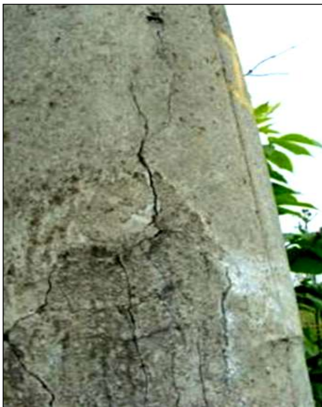
Фото 5. Опора № 14. Трещины шириной более 0,6мм, длиной до 1,5м.
