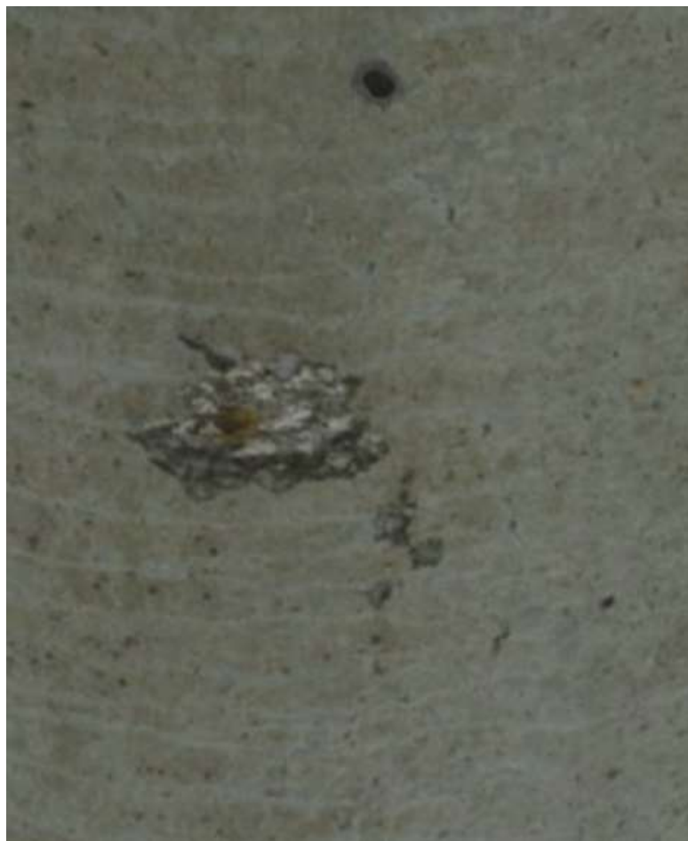
Фото 3. Опора № 7. Раковина в бетоне.
