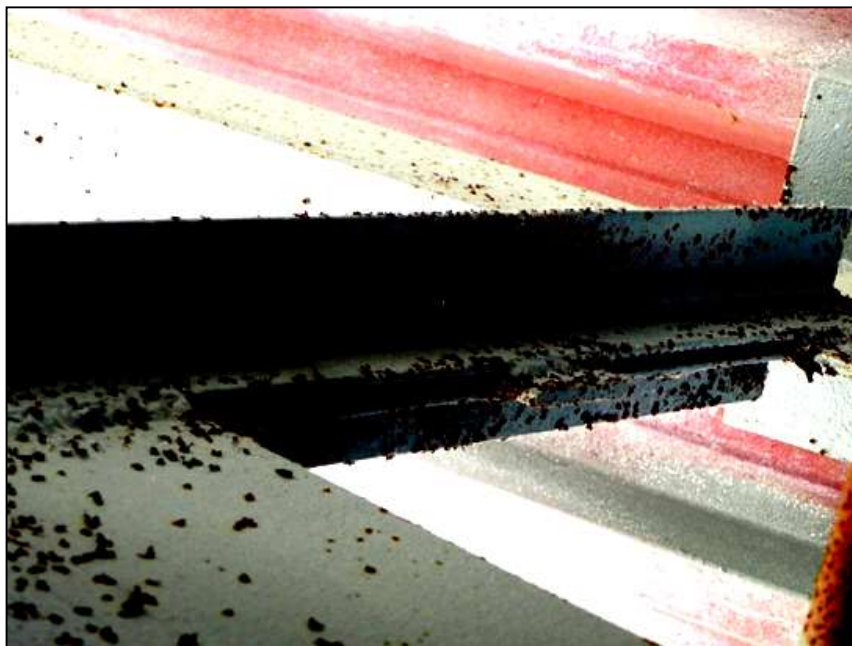
Фото 10. Металлические конструкции в отм. 4,000-8,300 м по всей длине эстакады. Разрушение антикоррозионной защиты с последующей поверхностной точечной коррозией.
