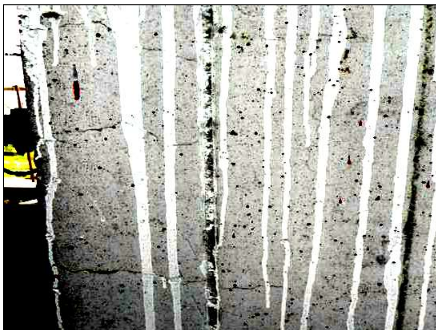
Фото 7. Колонны в осях «А/1-22». Усадочные трещины вдоль арматурных каркасов.
