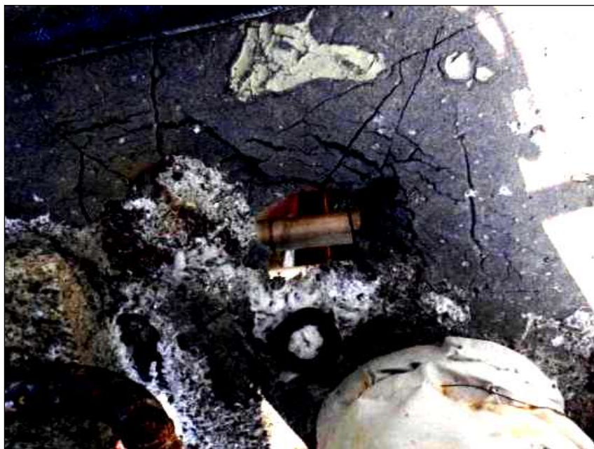
Фото 4. Плиты перекрытия на отм. 4,300м в осях «А/1-11, А/13-15, А/16-21». Сквозное отверстие в плитах перекрытия не предусмотренное проектом.
