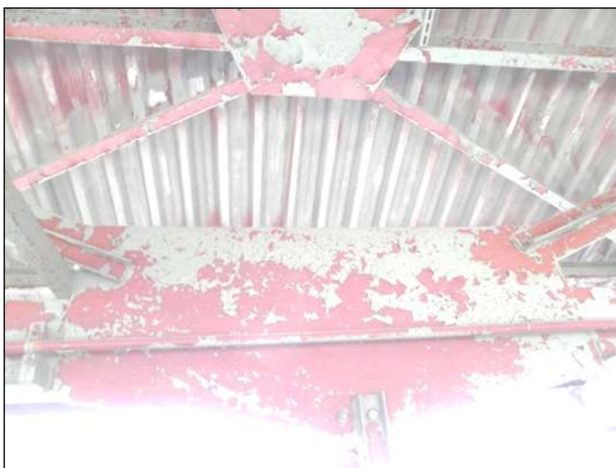
Фото 14. Металлические конструкции в отм. 6,500-8,300 м по всей длине эстакады. Разрушение антикоррозионной защиты до грунтовки.
