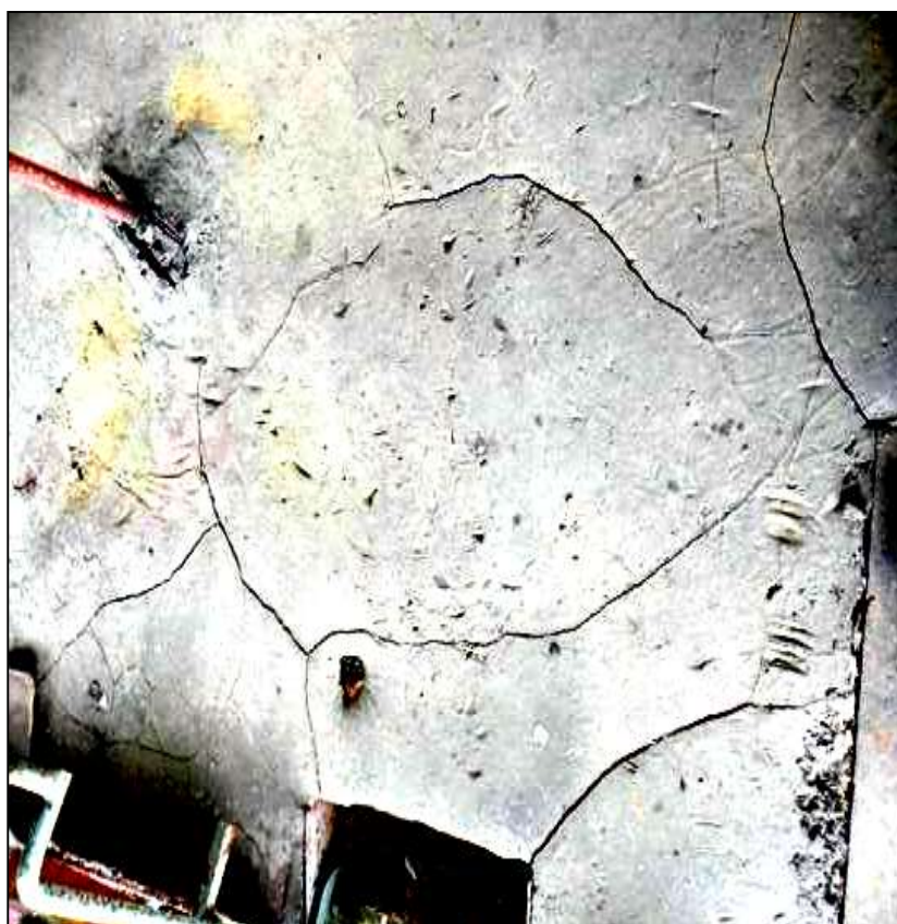
Фото 5. Плиты перекрытия по всей длине эстакады. Растрескивание цементной стяжки кровли.
