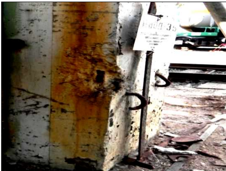
Фото 8. Колонна в осях «А/1». Скол угла с оголением и коррозией арматуры.
