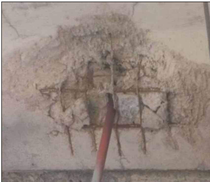
Фото 2. Плиты перекрытия на отм. 4,000м в осях «А/1-11, А/13-15, А/16-21». Оголение арматуры вокруг технологического проема.
