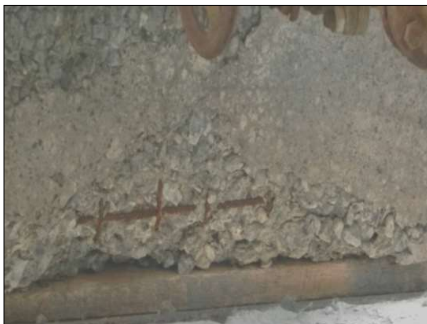
Фото 3. Плиты перекрытия на отм. 4,000м в осях «А/10-11». Разрушение ребра плиты перекрытия с оголением и коррозией арматуры.
