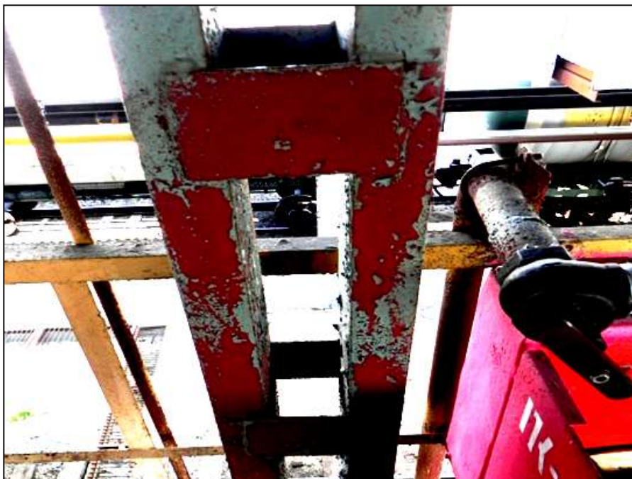
Фото 13. Металлические конструкции (стойки) в отм. 4,300-6,500 м по всей длине эстакады. Разрушение антикоррозионной защиты до грунтовки.
