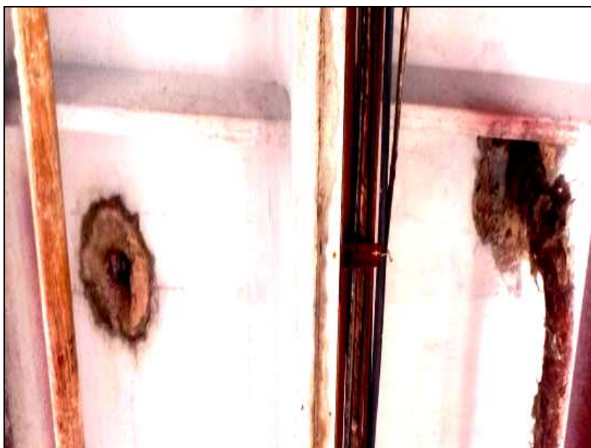
Фото 1. Плиты перекрытия на отм. 4,000 м в осях «А/1-11, А/13-15, А/16-21». Выявлено оголение арматуры вокруг технологического проема. Сквозное отверстие в плитах перекрытия.
