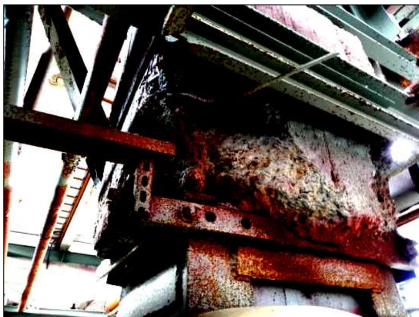
Фото 9. Колонна в осях «А/15». Некачественно выполнено усиление колонны, а именно: неровности и наплывы бетона.
