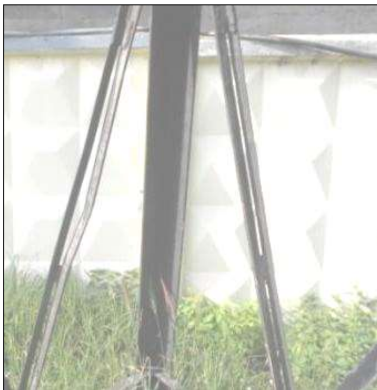
Фото 2. Деформация решетки. Опора № 3.
