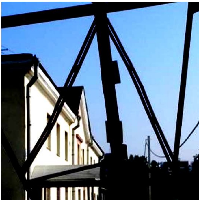
Фото 3. Деформация решетки. Опора № 3.
