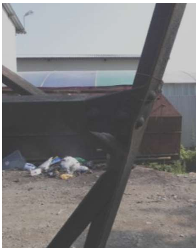
Фото 4. Деформация узла, коррозия. Опора № 4.
